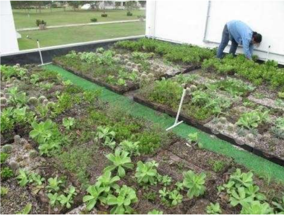
Figura N° 06. Techo verde extensivo en Buenos Aires- Argentina Fuente: Blog Argentina Sustentable
