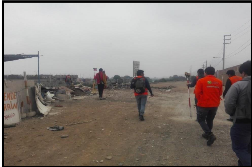
Figura 47 Inicio de trabajos de levantamiento del tramo del Río Moche en estudio
