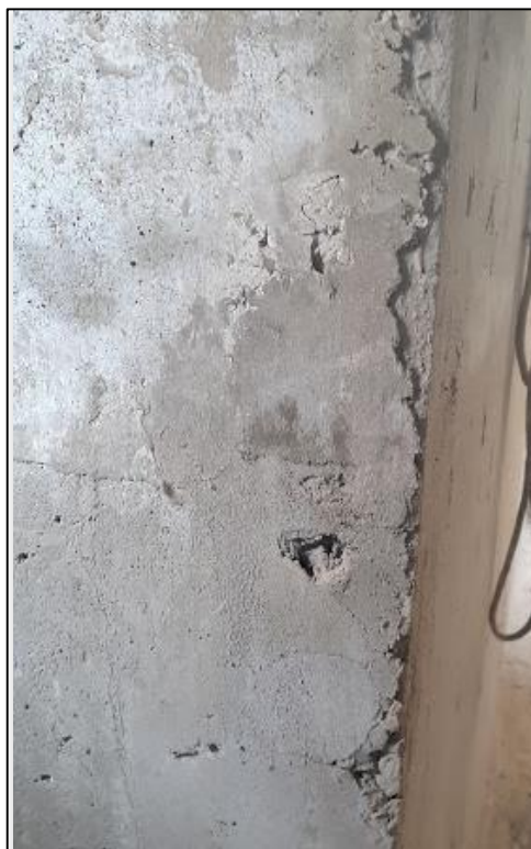
Figura 31. Fisuramiento Vivienda N°9
