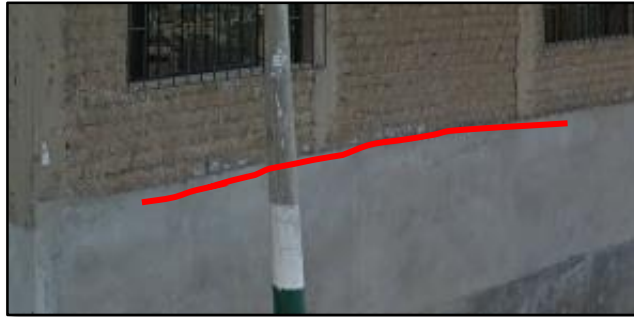
Figura 32. Asentamiento Vivienda N°9
