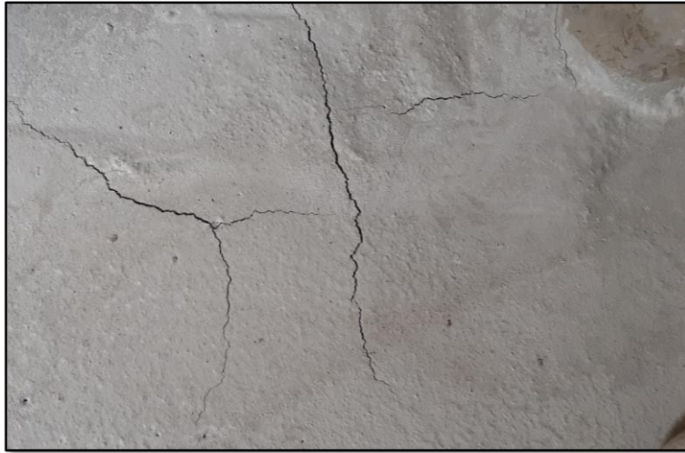
Figura 30. Agrietamiento Vivienda N°9
