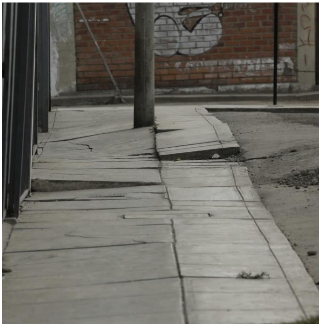
Figura 1.1. Hundimiento de Bermas
