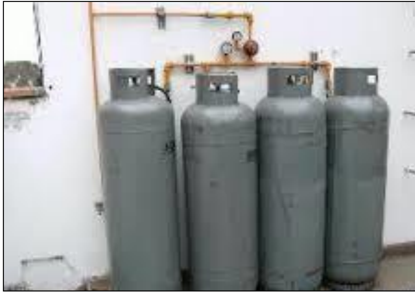
Figura 9. Instalación de suministro de gas a las incubadoras de huevos
