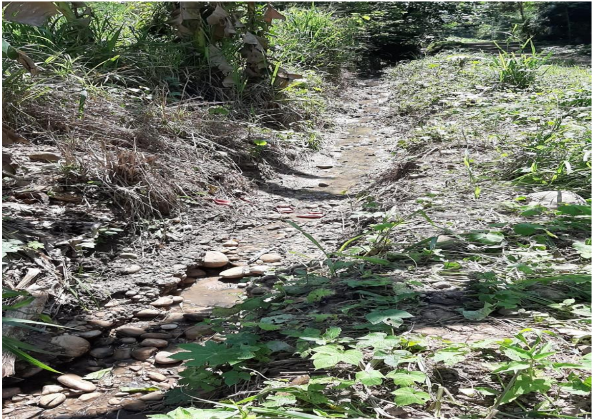
Anexo 7. Cuneta elaborada de forma manual por los pobladores por donde circulan sus aguas residuales.
