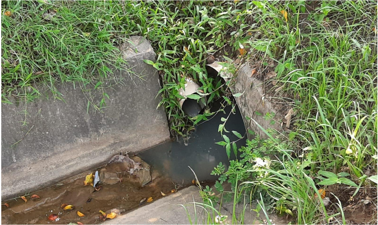
Anexo 6. Tubería de una vivienda que desemboca en una cuneta.
