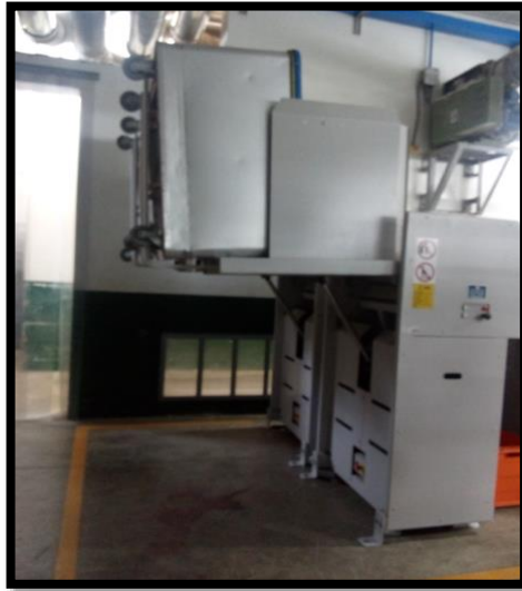
Figura 12: Zona de trabajo insegura en el área de Hilandería de Cía. Industrial Nuevo Mundo S.A., 2019
