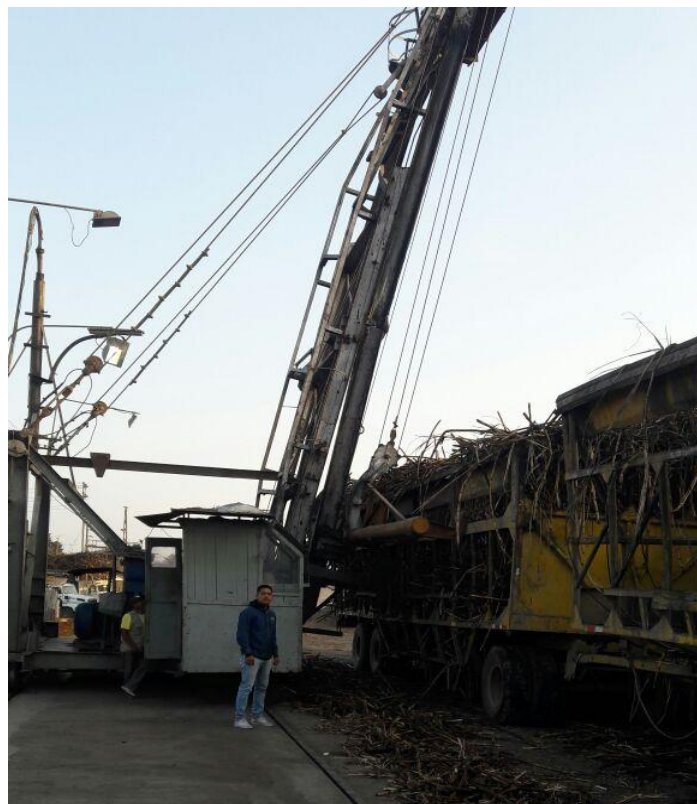
Figura 4. Grúa Hilo iniciando el proceso de almacenamiento de caña de azúcar
