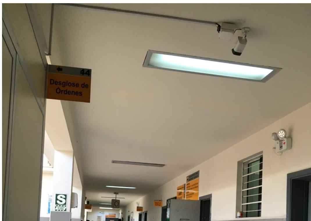
Fig. 11: Foto del techo del pasillo más concurrido, sin rociadores contra incendios. Fuente: Elaboración propia, 2019.
