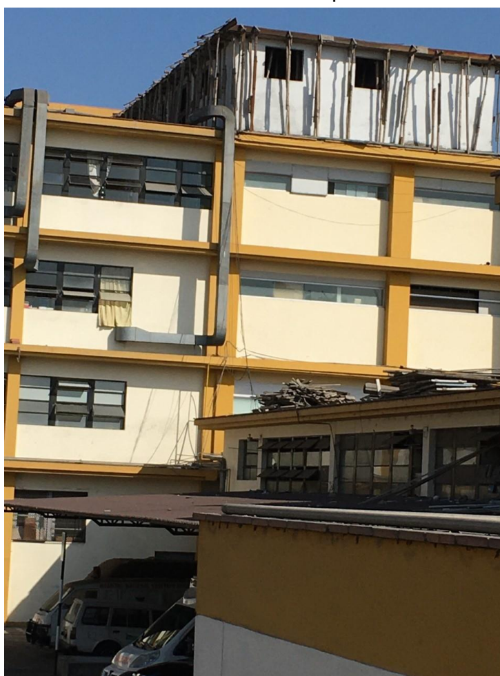
Fig. 8: Foto de techo estructural dañado. Fuente: Elaboración propia, 2019.
