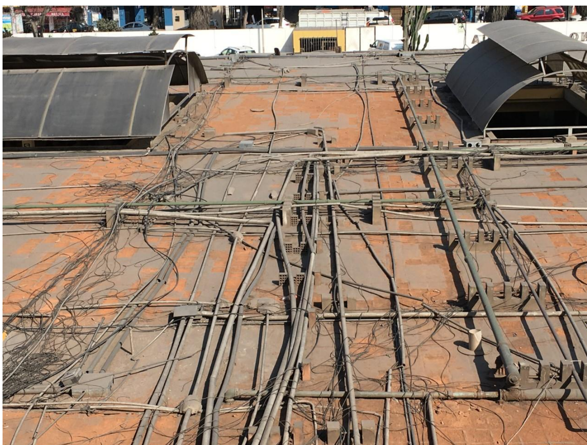
Fig. 9: Foto del cableado eléctrico, junto con las tuberías de agua, ubicadas en el techo del área de diagnóstico. Fuente: Elaboración propia, 2019.
