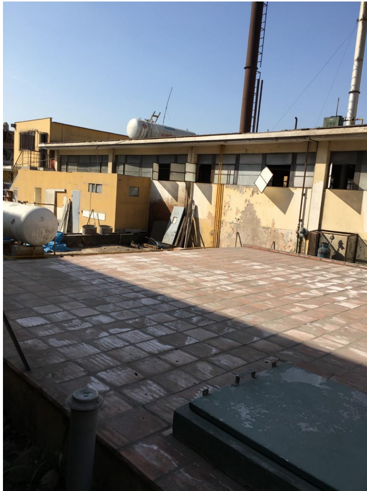
Fig. 12: Foto del área en peor estado del Hospital Nacional Cayetano Heredia. Fuente: Elaboración propia, 2019.
