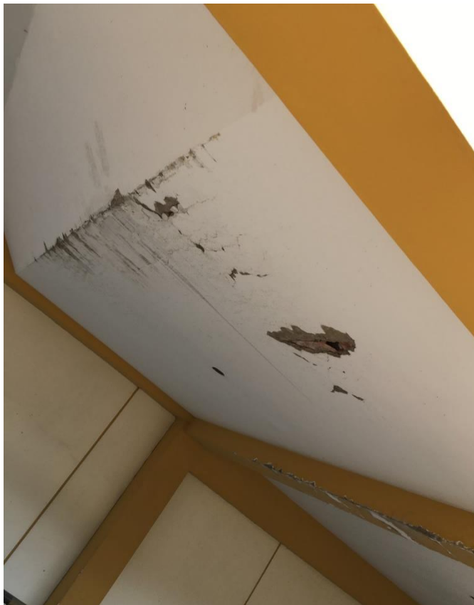
Fig. 7: Foto de techo estructural dañado. Fuente: Elaboración propia, 2019.
