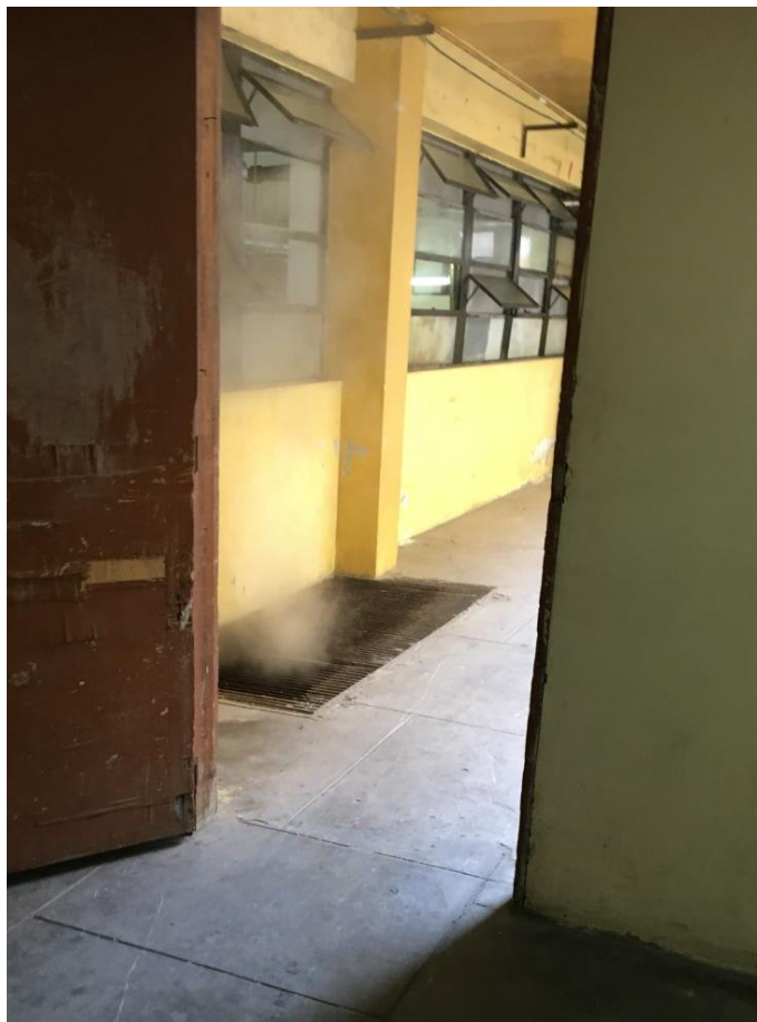
Fig. 6: Foto de sótano, contaminación aérea. Fuente: Elaboración propia, 2019.
