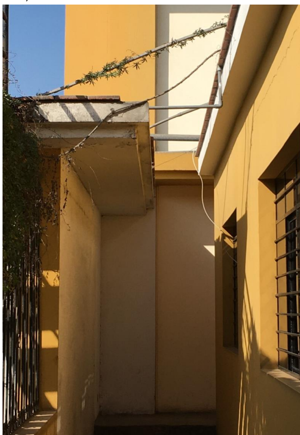
Fig. 10: Foto de tubos de agua potable, que pasan entre los techos del hospital. Fuente: Elaboración propia, 2019.
