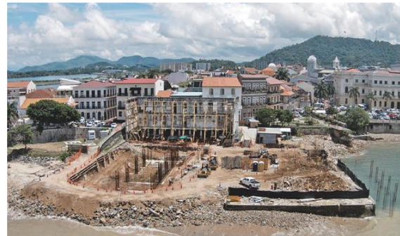
Figura 61: Impacto ambiental de una construcción. Tomado de: https://www.prensa.com/locales/Costas-Casco-Antiguo-riesgo_0_4504049674.html
