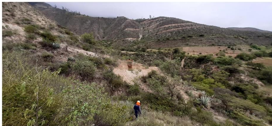
FOTO N°8.- RED DE CONDUCCIÓN
