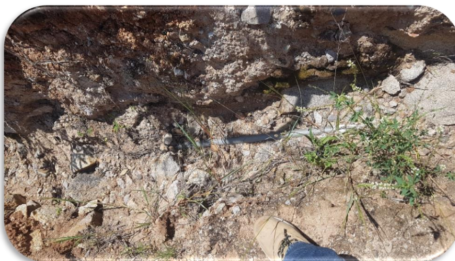
Figura N° 01. Exposición de tubería en Línea de Aducción.
