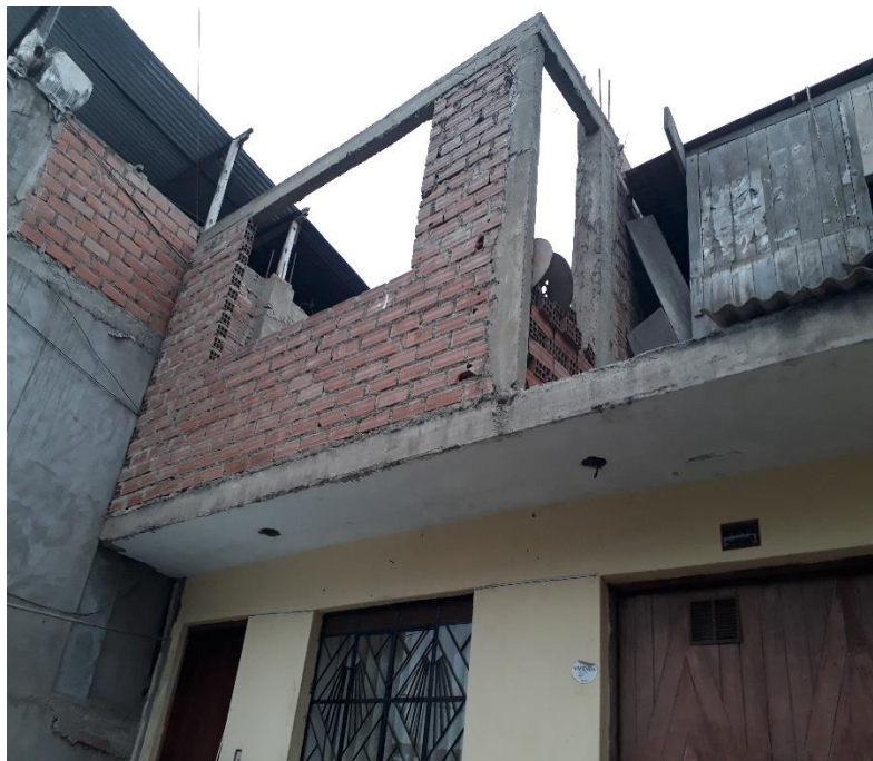
Materiales mal empleados en la construcción y un diseño inadecuado.
