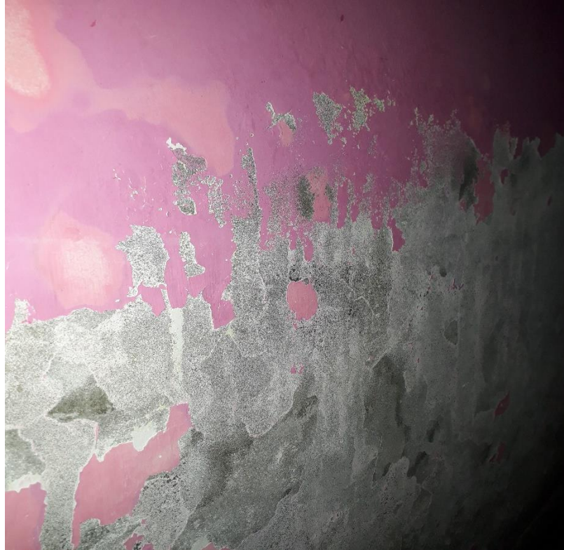
Presencia de la humedad y consecuentemente el salitre (eflorescencia).
