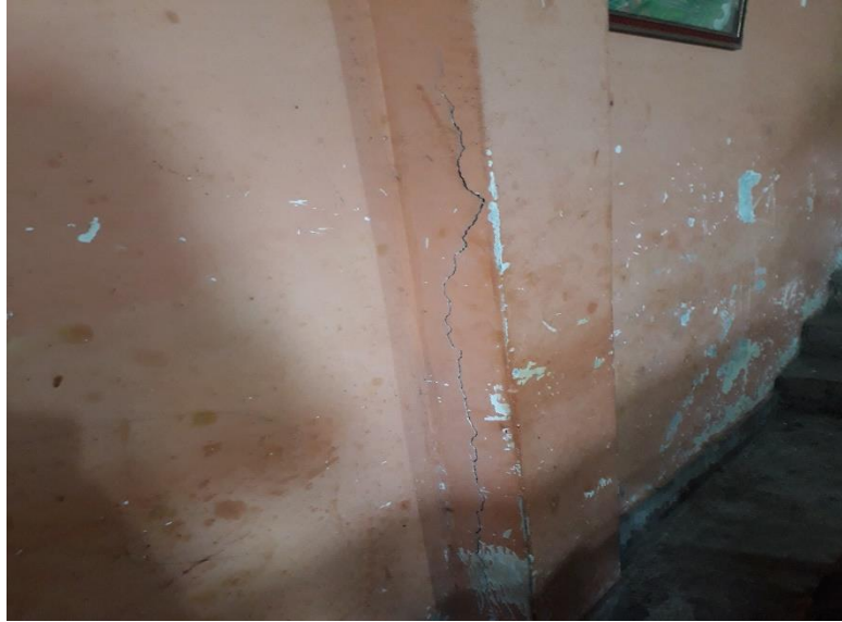
Presencia de grieta en la columna, se puede opinar que es por una falla de asentamiento diferencial de la cimentación.
