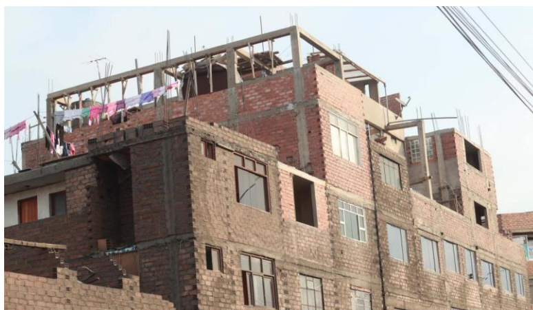
Figura 2. Una vivienda en la avenida universitaria, con el cruce de la avenida José Granda, en San Martín de Porres cuya estructura desafía la suerte
