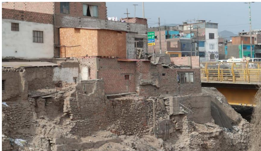
Figura 1. En San Martín de Porres, frente al río Rímac, también se distinguen viviendas que desafían las normas de construcción
