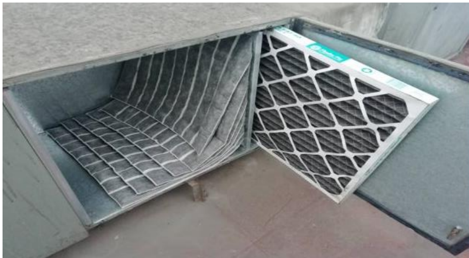
Ilustración 15: Reemplazo de filtros de alta eficiencia
