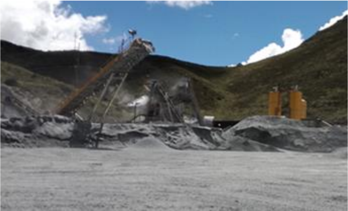
Figura 41: Vista de la Chancadora procesadora de agregados para núcleo asfáltico, fuente elaboración propia.
