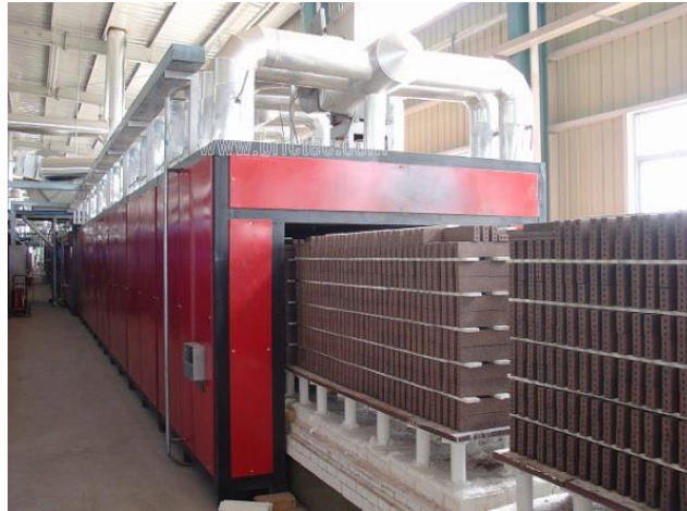
Figura 7. Horno túnel para quemar ladrillo, fuente ( http://brictec.com )
