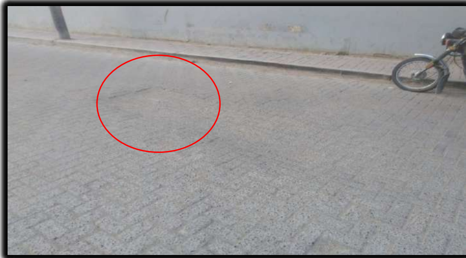
Figura 11. Deformidad de la Vía
