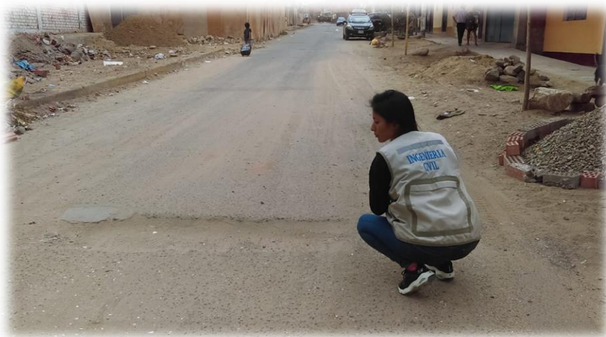
Figura 26: Fallas por hundimiento
