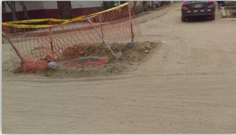
Figura 27: Avenida interrumpida por cambio de tuberías de desagüe
