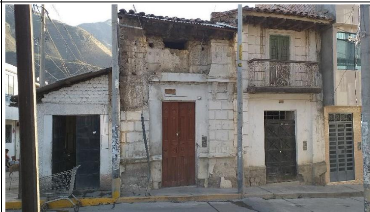
Imagen 104: Casonas, con muros deteriorados, ubicadas en una esquina de la plaza de armas.
