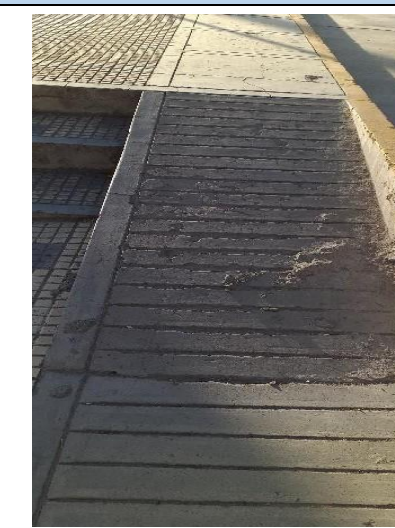
Ilustración 66: Rampa ubicada en la plaza de armas con presencia de grietas.
