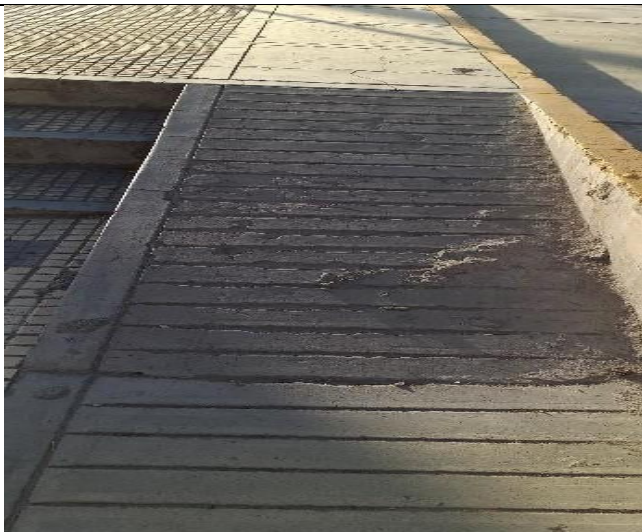
Imagen 71: Rampa ubicada en la plaza de armas con presencia de grietas.
