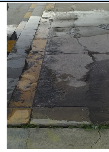
Ilustración 65: Grietas en un camino de la plaza de armas.
