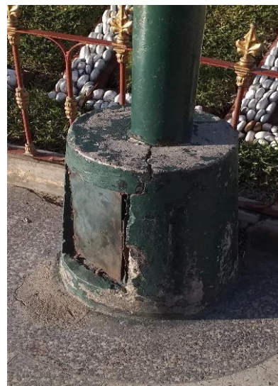
Ilustración 77: Base de faro, despintado y con una grieta en su superficie.
