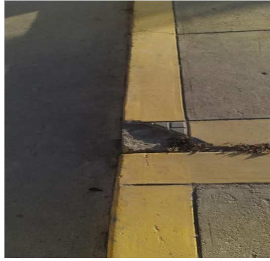
Imagen 74: Desprendimiento del concreto en uno de los caminos de la plaza de armas.
