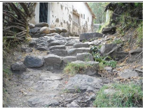
Imagen 19: Escalera de piedras en mal estado en el segundo camino propuesto.
