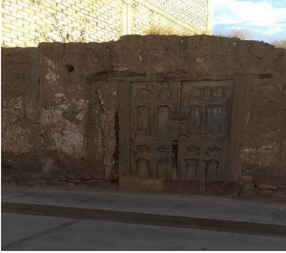
Imagen 101: Fachada de antigua casona, con muros y puerta en estado de deterioro, ubicada cerca a la plaza de armas.
