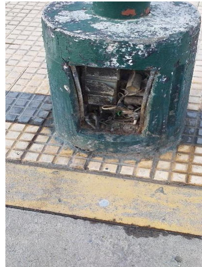
Ilustración 78: Cables expuestos en un faro.
