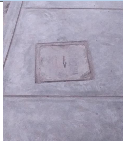
Ilustración 82: Tapa de caja de servicio de desagüe.
