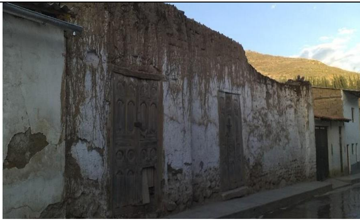
Imagen 103: Fachada de casona, con muros y puertas deterioradas, ubicada en la avenida usada para llegar al cerro Llusho.
