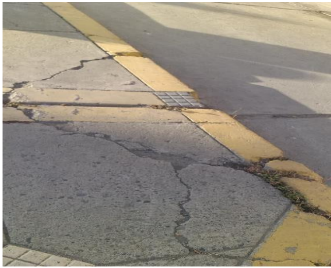
Imagen 73: Grietas en uno de los caminos de la plaza de armas.
