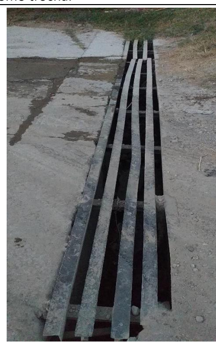
Imagen 90: Alcantarilla para el desfogue de aguas pluviales.
