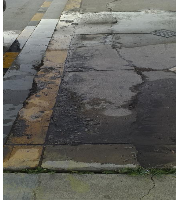
Imagen 70: Grietas en un camino de la plaza de armas.
