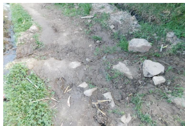
Imagen 13: Parte del segundo camino propuesto deteriorado por el agua.
