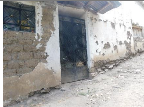
Imagen 21: Vivienda con muros de adobe ubicada en el recorrido del segundo camino propuesto.
