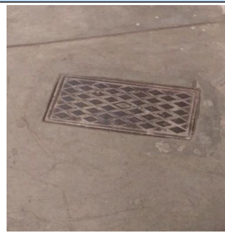
Ilustración 83: Tapa de caja de servicio de agua.
