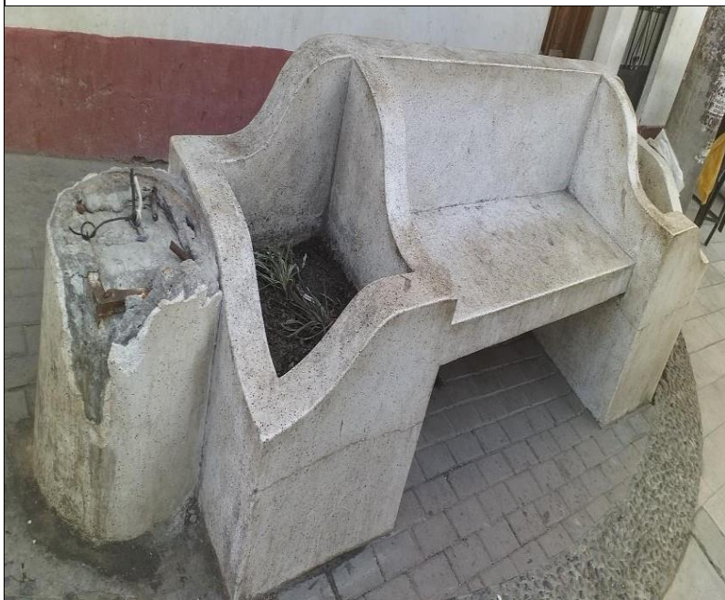
Imagen 77: Banca ubicada en la calle principal de acceso peatonal al distrito, con presencia de suciedad en su superficie.
