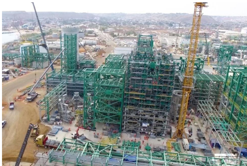
Figura 1. Montaje de estructuras metálicas de la empresa Técnicas metálicas en el proyecto de modernización de la refinería de Talara
