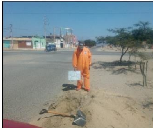
FOTOS 12: SE OBSERVA UNA VISTA PANORÁMICA DE LA EXCAVACION DE LA CALICATA C-06.
