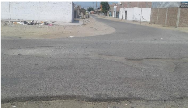
Presencia de fallas en la Av. Integración
