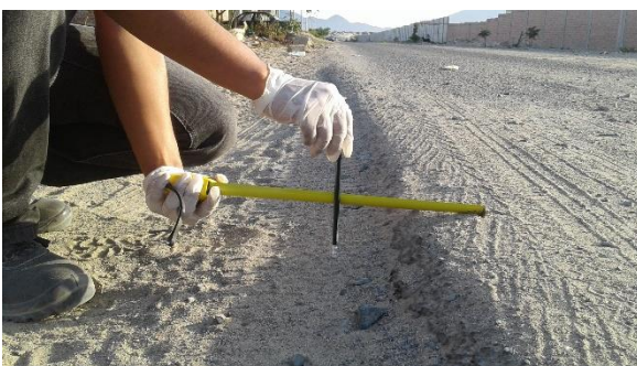
Presencia de Desnivel de Berma en la calle 2
