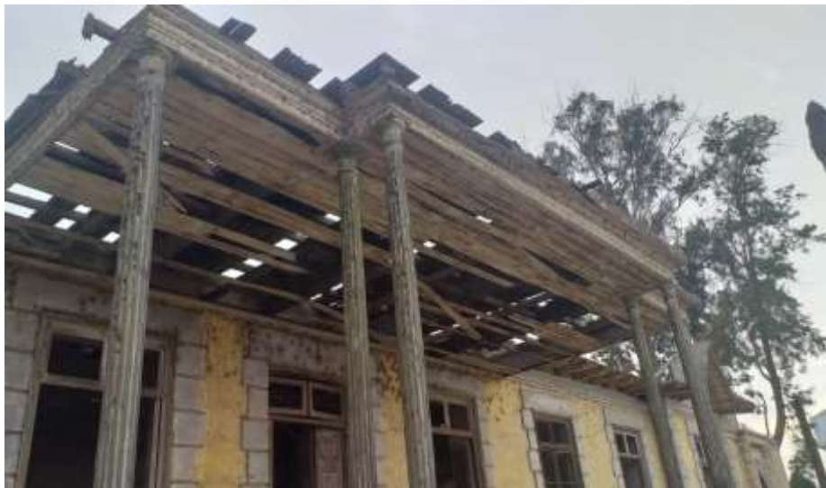
Figura 7: Foto del mal estado de conservación del techo de la Casa Hacienda El Fortin
