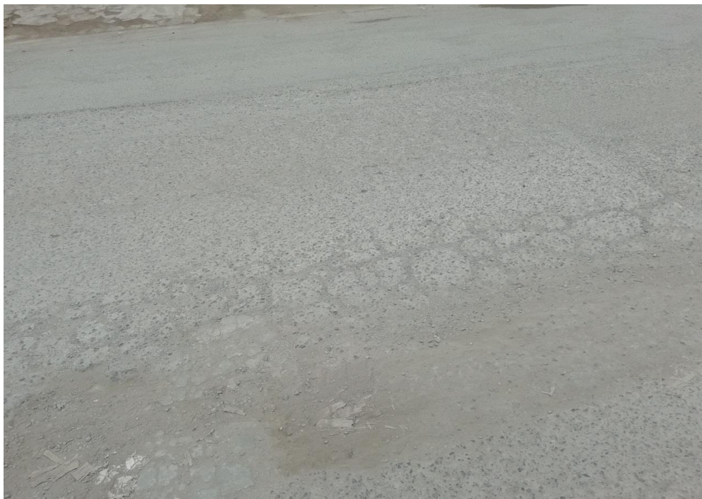
Fotografía 15. M14 Perdida de ligante y Bache
