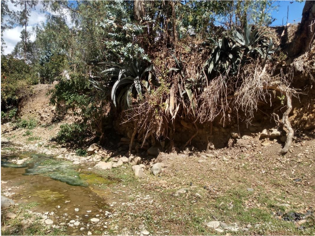
Figura 21. Socavación de margen derecho tramo 2.
