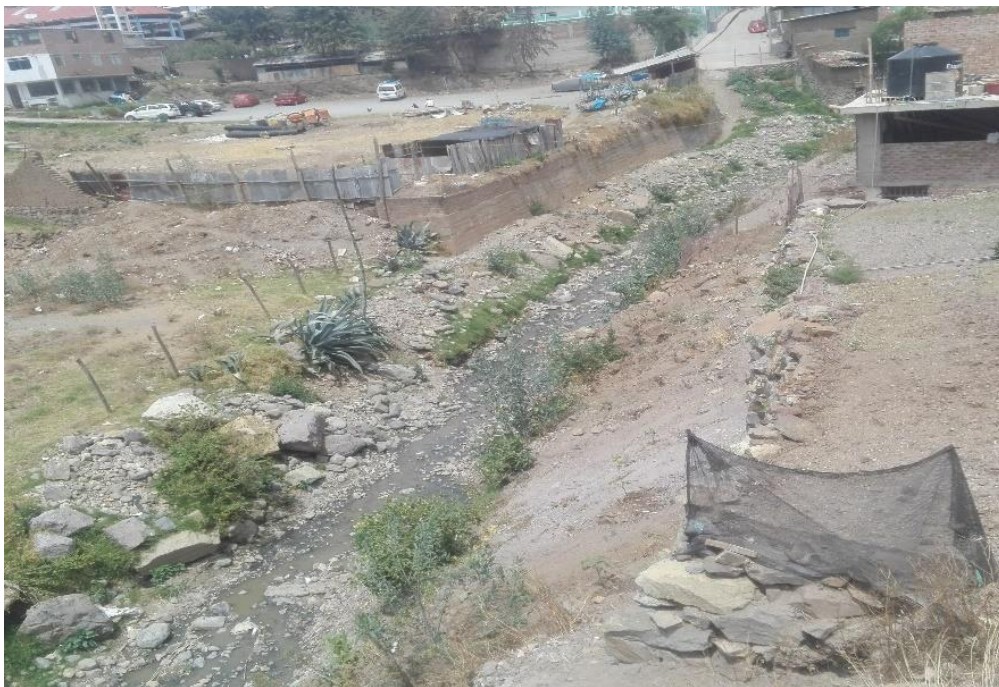
Figura 24. Pérdida de terreno margen derecho en la ciudad de Otuzco tramo 3.
