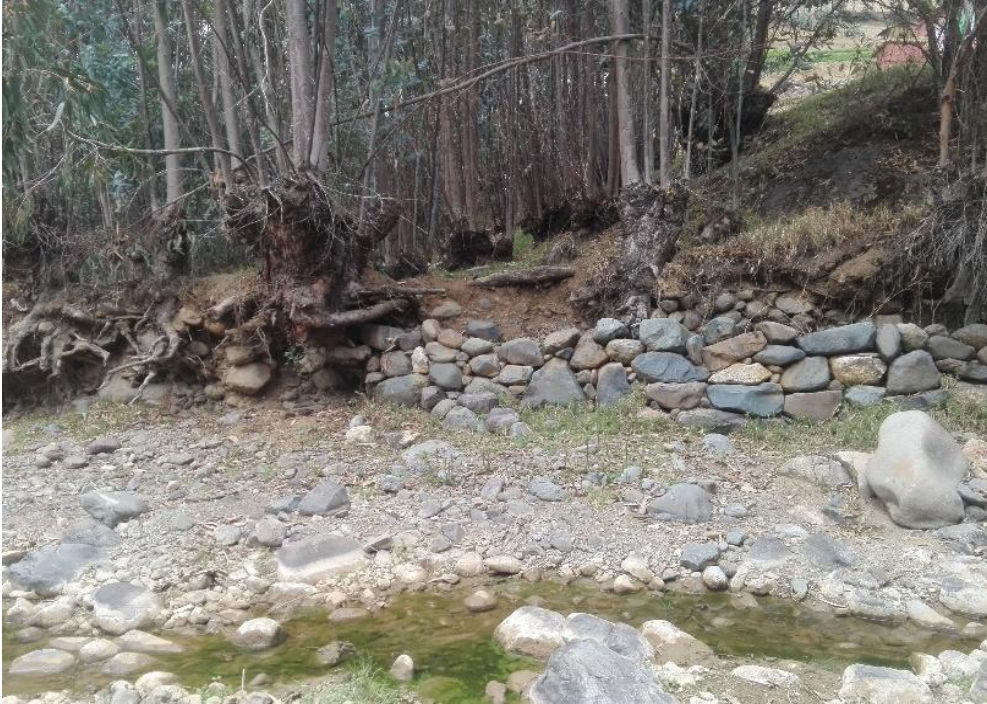
Figura 20. Socavación producida por la fuerza del agua en el margen derecho tramo 2
