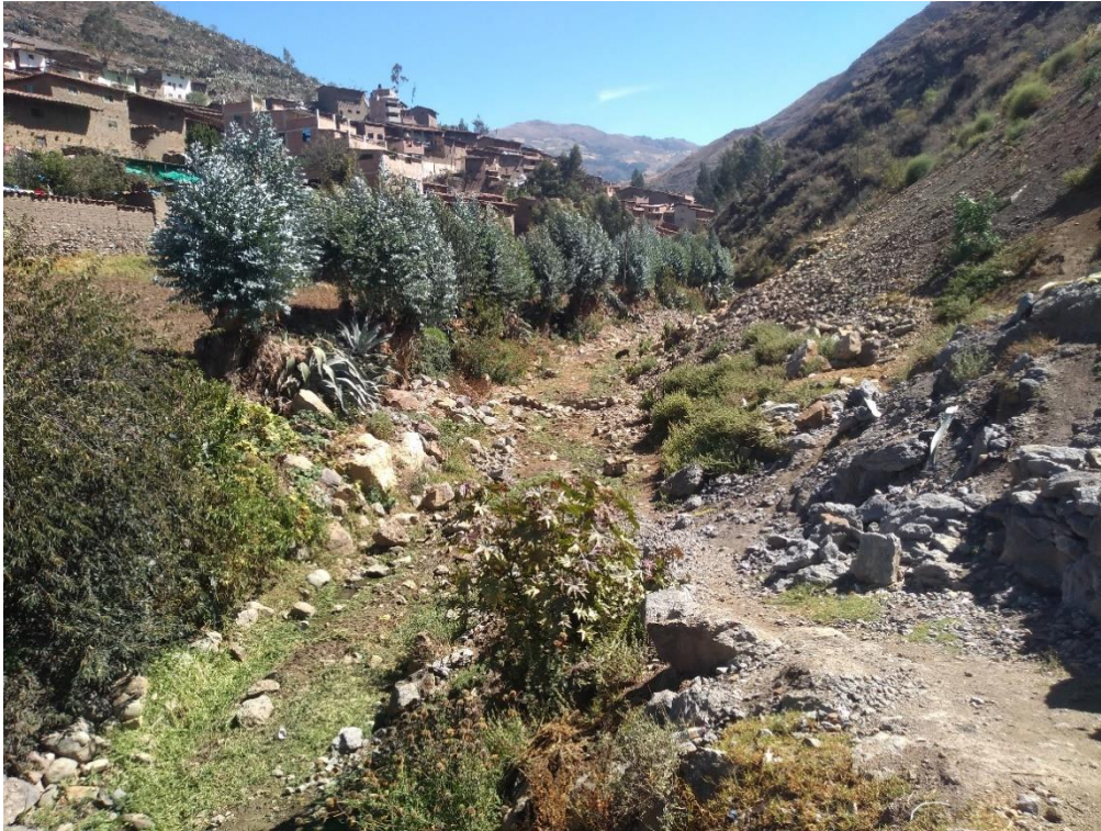
Figura 23. Pérdida de terreno en ambos márgenes del tercer tramo.
