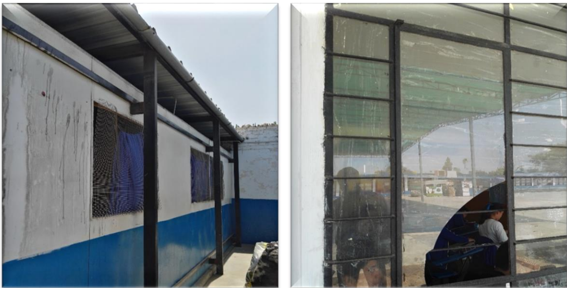
Figura 34. Paredes de triplay en salones / vidrios rotos en las ventanas.
