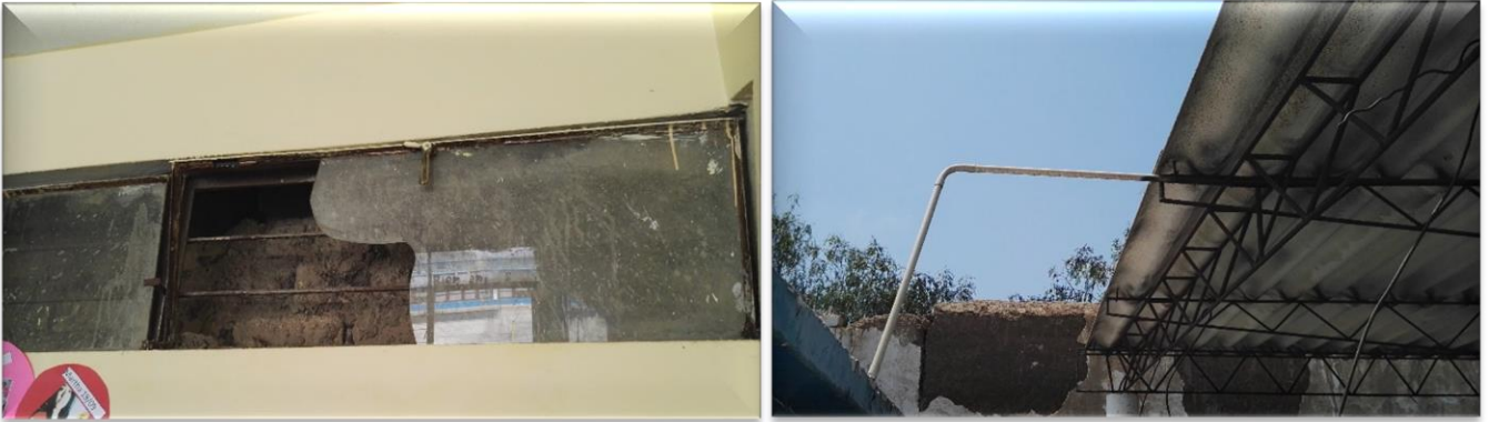
Figura 35. Ventanas de salones tapadas / instalaciones eléctricas expuestas.
