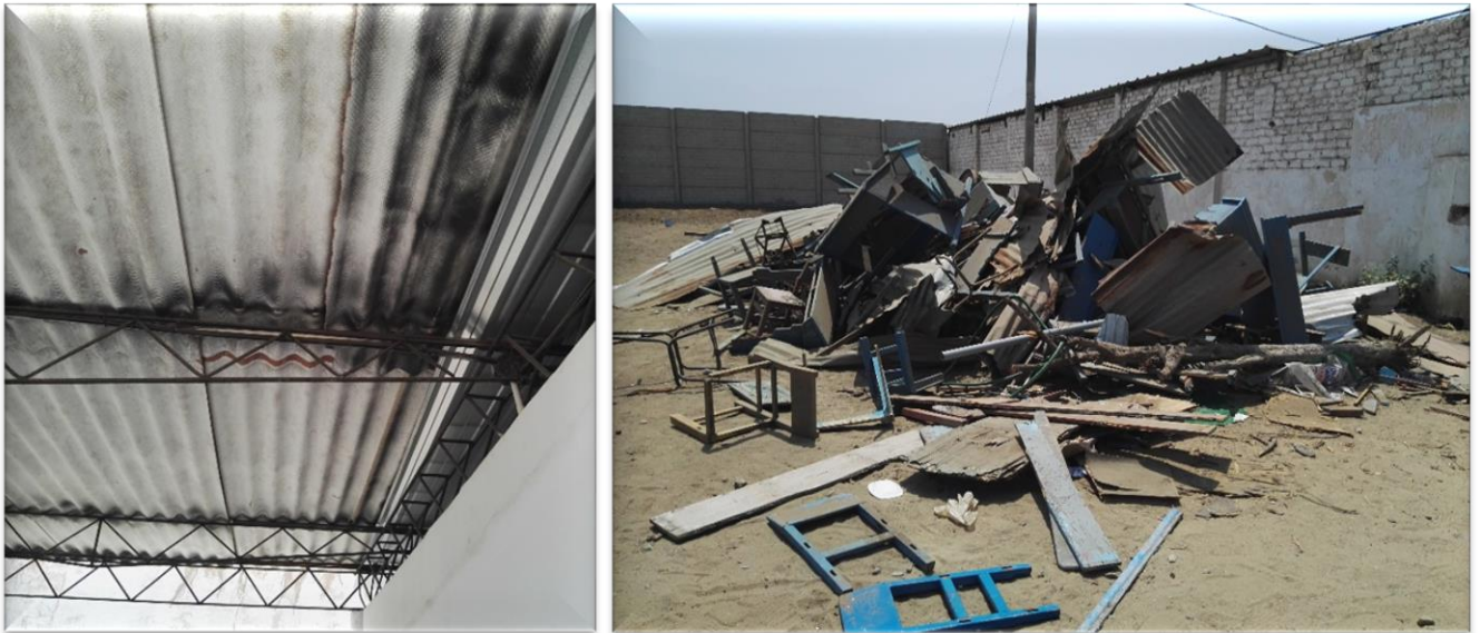
Figura 36. Coberturas de calamina / restos de mobiliario escolar al costado de losa.
