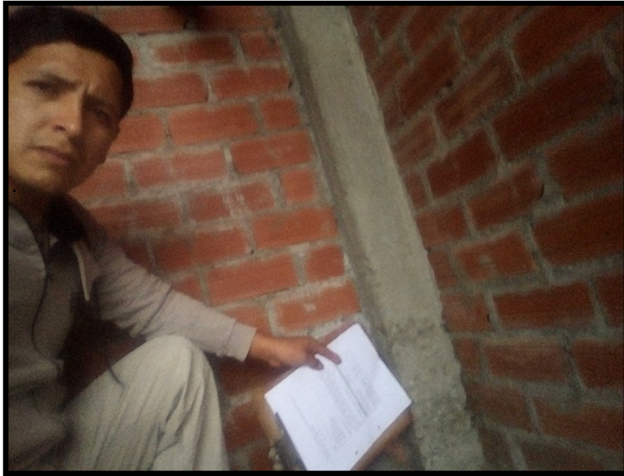
Columna con presencia de cangrejas.
