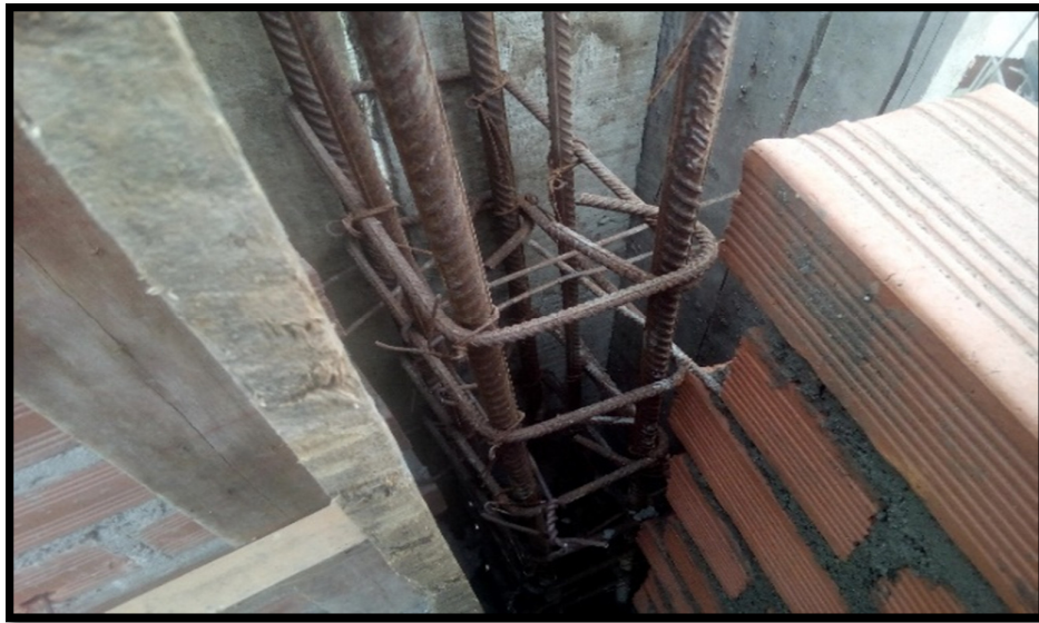
El lugar de colocación del concreto tampoco es tratado como exige la norma (no es limpiado ni usan ningún tipo de desmoldantes).
