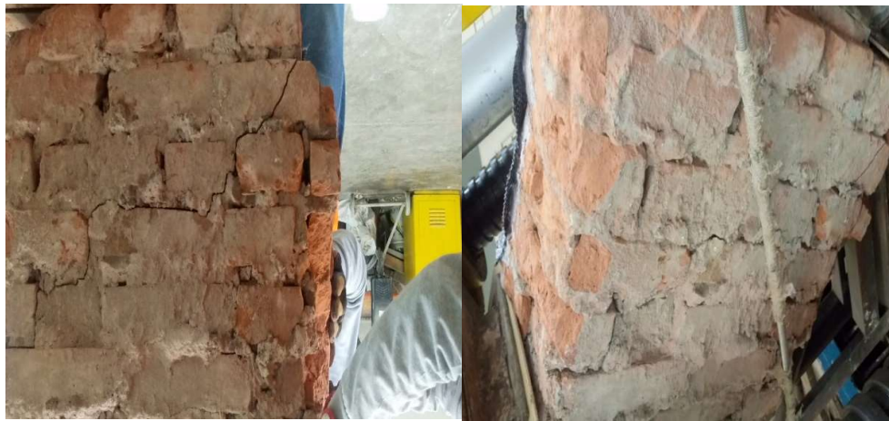
Figura 31. Espécimen con Fibra de Carbono después de ser Ensayado a Compresión Diagonal con Murete sin colapsar.
