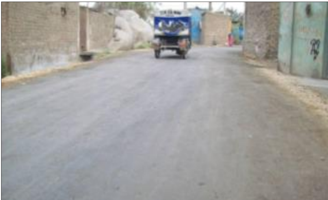
Figura 5. El acabado de la superficie de rodadura en Carapongo.
