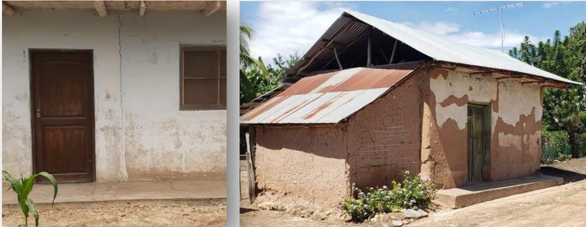
Figura 17. Evaluación de daños Fuente: Propia
