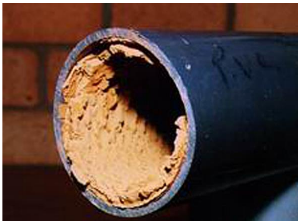
Figura 8: Tubería con incrustaciones de calcio.
