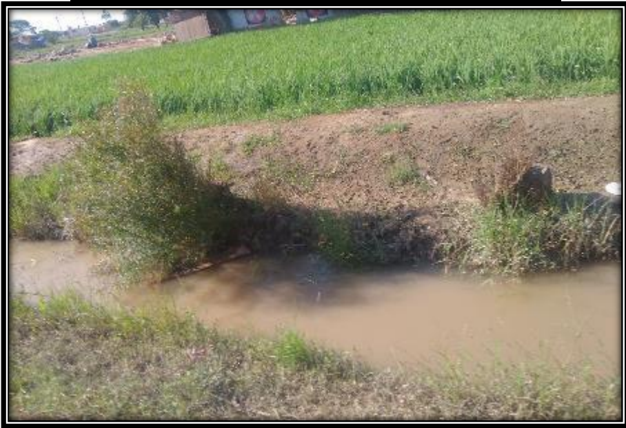
FOTO 04: Camino de vigilancia en mal estado
