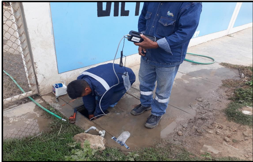
Figura N° 15: Instalación de Datalogger
