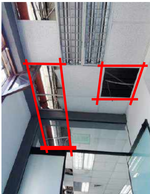
Figura 5. Infraestructura techo CAM sede Municipalidad Santiago de Surco
