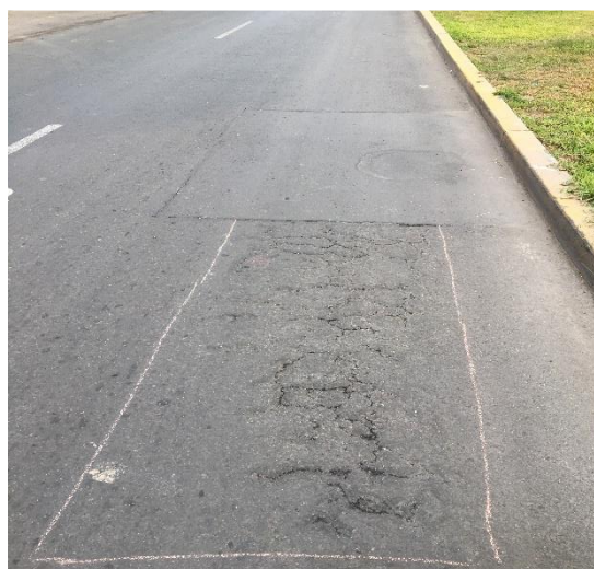
Figura 1. Av. Carlos Izaguirre - Falla en el pavimento (Arietamiento en bloque).
