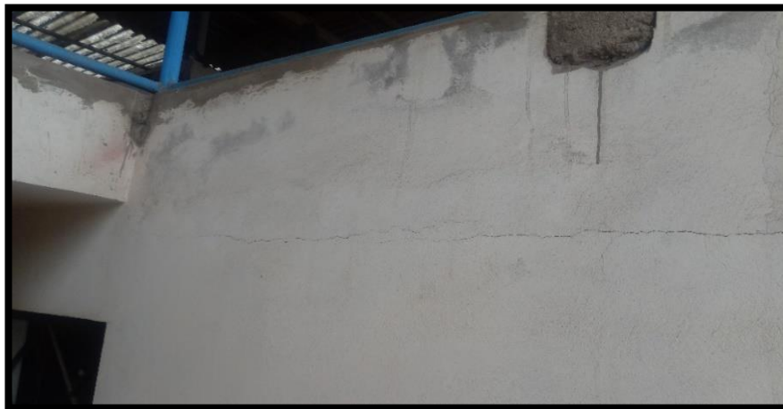
Figura 25: Evidencia de fisura en la unión de muro y losa aligerada. Fuente propia
