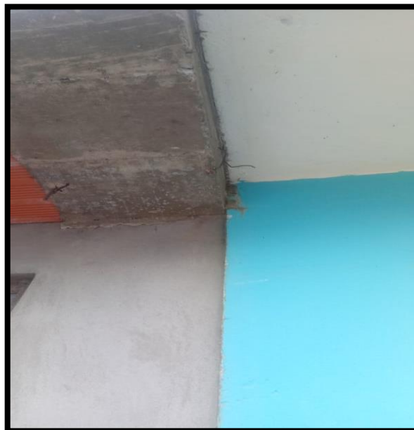
Figura 20: Junta sin holgura suficiente
