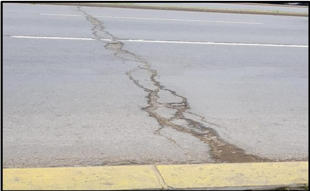
Figura 9. Falla por parcheo Fuente: Elaboración propia
