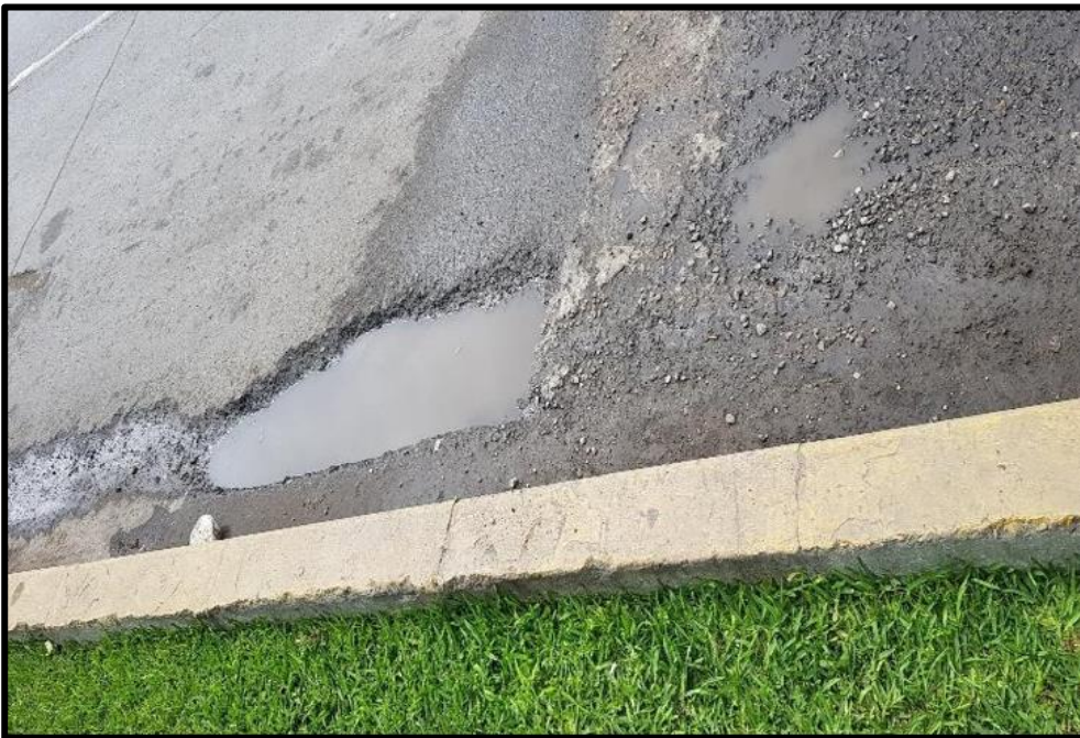
Figura 13. Falla por depresión
