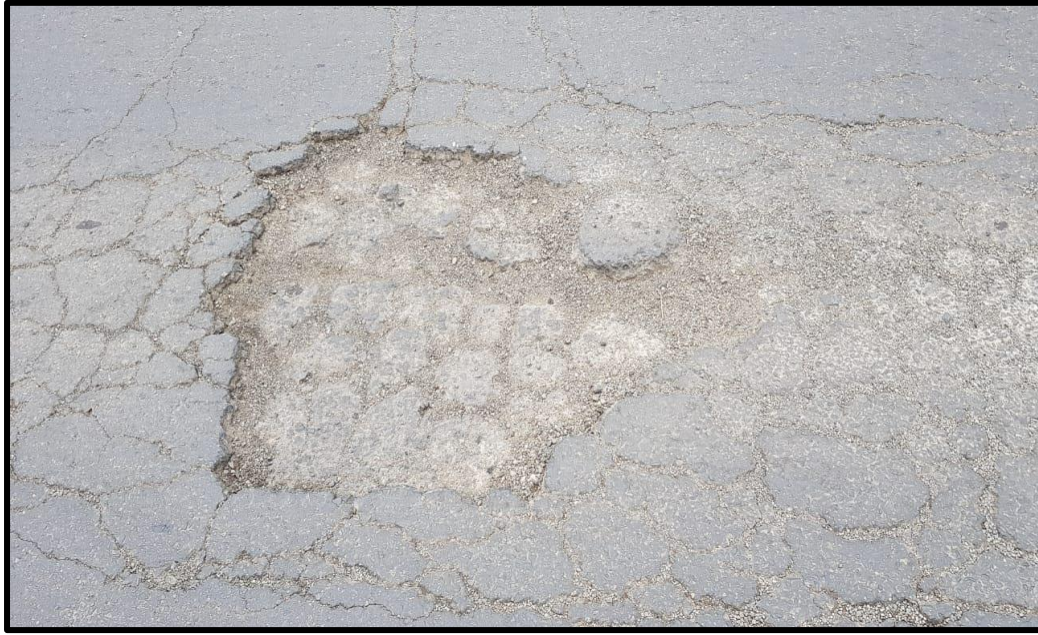
Figura 10. Falla por huecos
