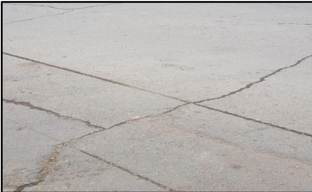
Figura 11. Falla por grietas longitudinal y vertical
