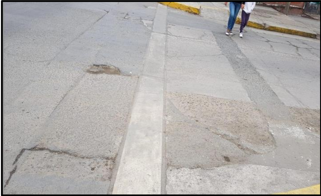
Figura 8. Fallas por junta de deflexión Fuente: Elaboración Propia
