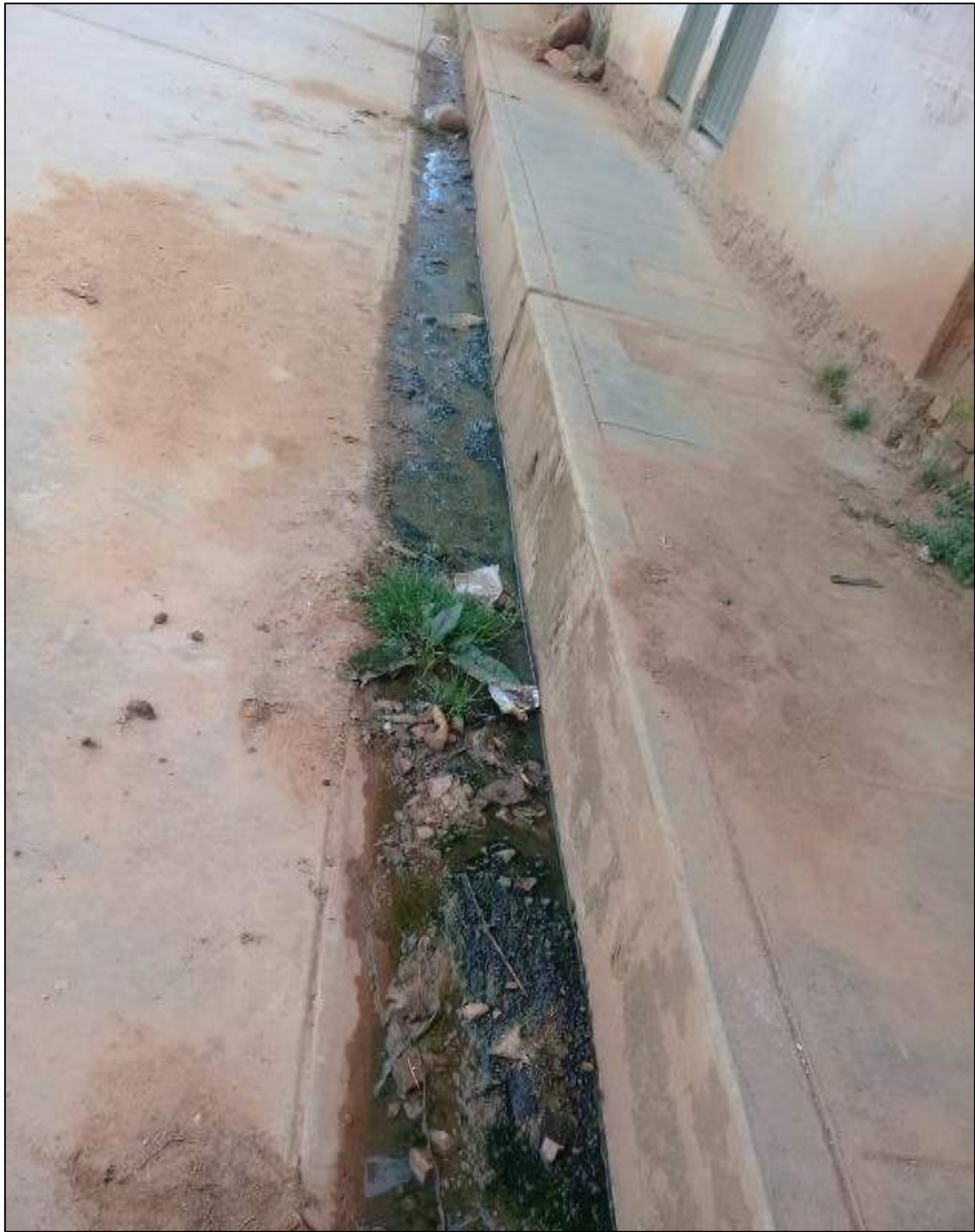
FOTOGRAFÍA N° 04: Se observa la retención de agua con sedimentos en las cunetas existentes, debido a que, no se tuvo en cuenta el cálculo de pendientes.
