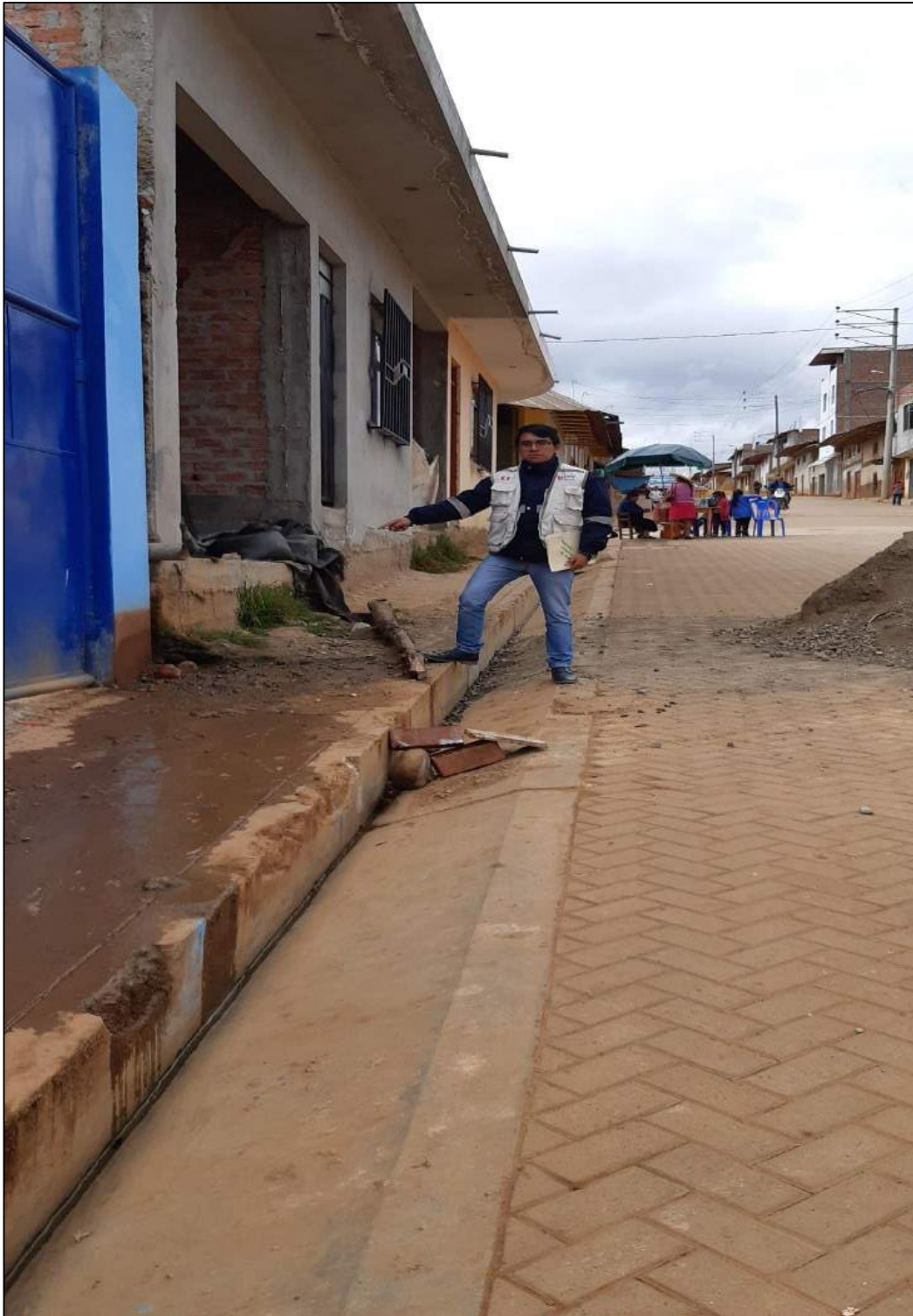
FOTOGRAFÍA N° 03: Se aprecia el canal de evacuación para acción de aguas lluvias existente, ubicado en la Av. Manuel Prado, así mismo, no cuenta con un diseño optimo, ya que, no tiene características geométricas lo suficientemente adecuadas.
