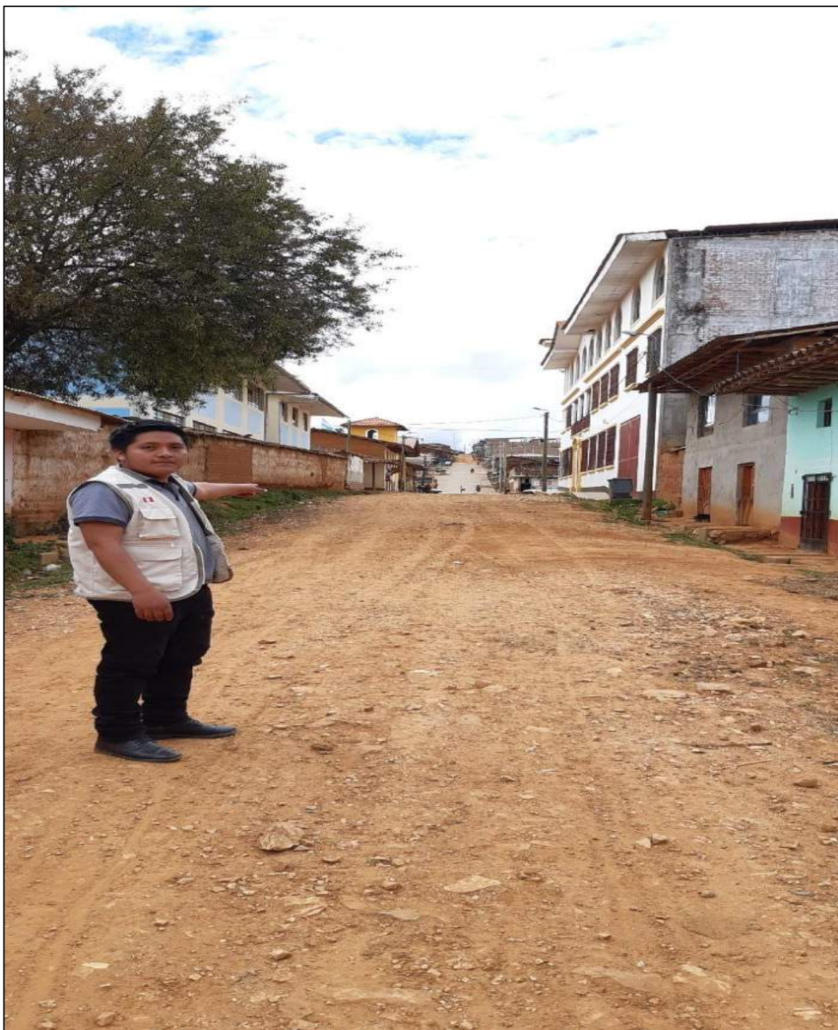
FOTOGRAFÍA N° 01: Se observa la falta de un sistema de drenaje para evacuación de aguas lluvias, ubicada en la Av. San Pedro.
