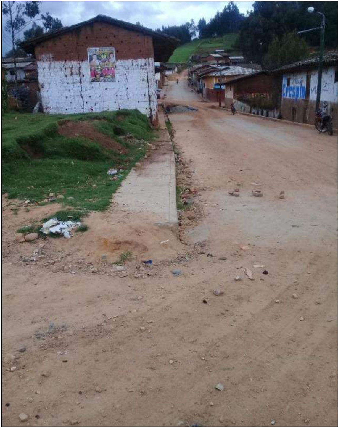
FOTOGRAFÍA N° 02: La ubicación de cunetas existentes están obstruidas, puesto que, la acción de aguas lluvias, trae consigo desde la parte alta hasta la baja todo tipo de material y objetos.
