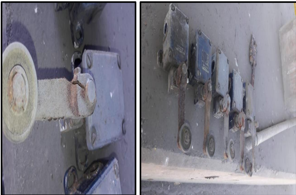
Figura 45. Mantenimiento de finales de carrera para regular contrapeso – antes foto 1 y 2
