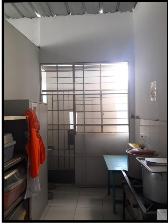
Foto N° 20: Vista de la cocina, se verificó que no cumple las condiciones técnicas para ofrecer la dispensa de alimentos a los niños.
