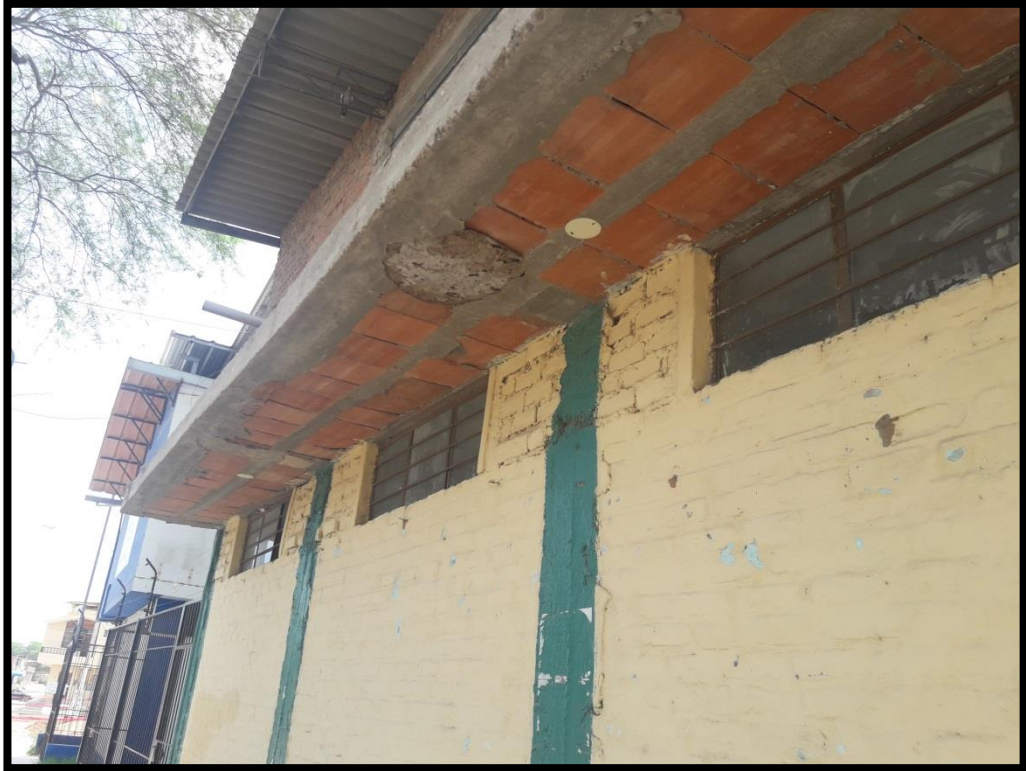
Foto N°10 y 11: Vista de los daños ocasionados a la estructura de la columna donde los fierros se han doblado y no se han seguido con la sección de la columna.
