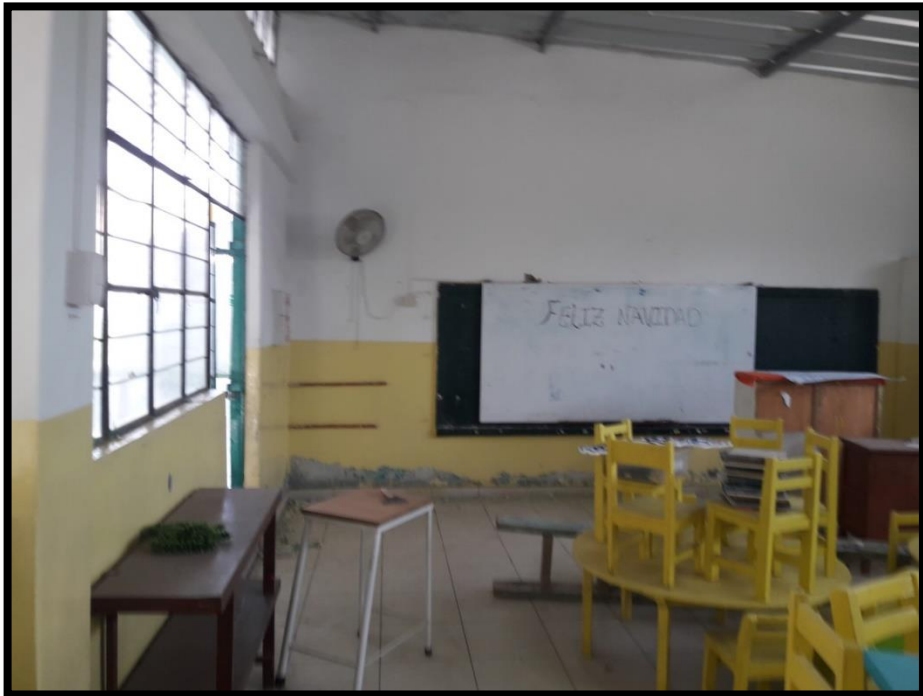
Foto N° 12, 13 y 14: Vista elevación del Módulo B en regular estado de conservación.
