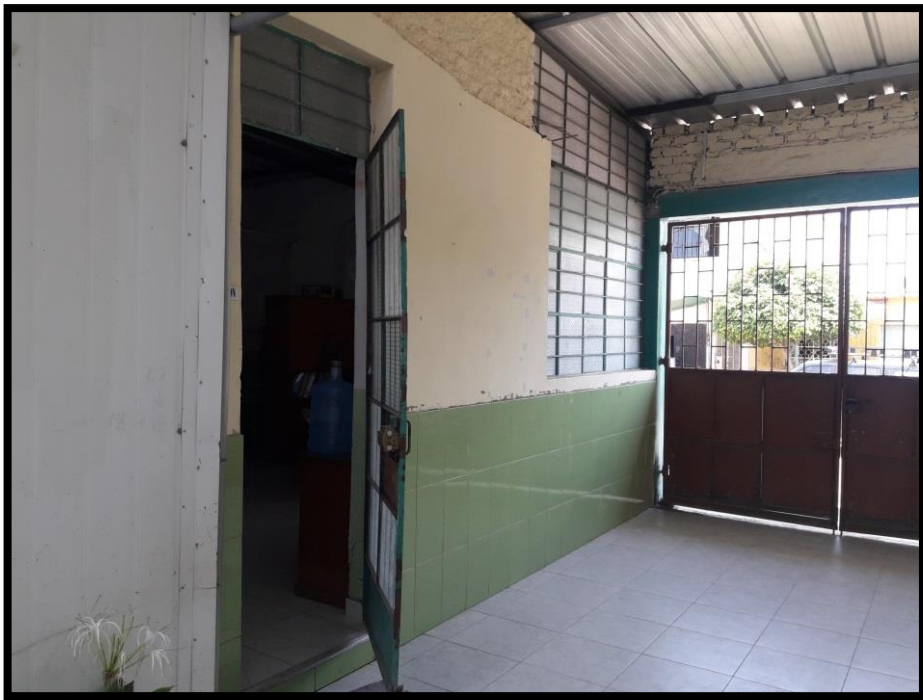
Foto N° 15 y 16: Vista elevación del Módulo C, cuenta con cobertura liviana de Calaminon TR4. Se pudo constatar el deterioro de la estructura.
