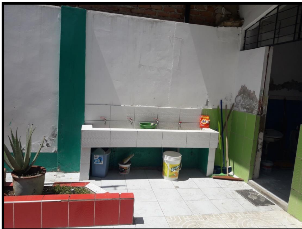
Foto N° 27: Vista a más detalle del estado actual de los lavatorios hacia el exterior, el cual se evidencia el desgaste de los materiales, por efectos de las lluvias.
