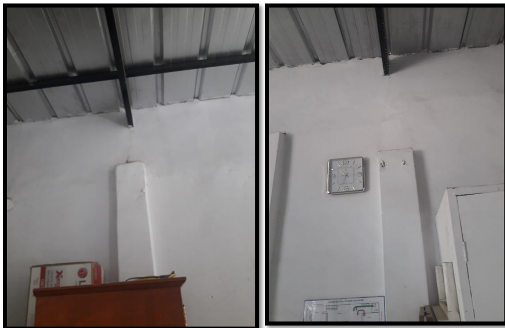
Foto N°17 y 18: Vista del fisuramiento de las estructuras de soporte de la cobertura, lo cual constituye peligro de desplome ante cualquier evento, así mismo se evidencia la discontinuidad de las columnas.
