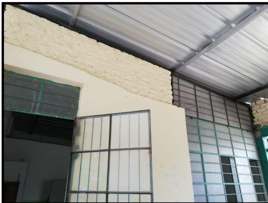
Foto N° 19: Vista de la falta de continuidad de estructuras de confinamiento, lo cual constituye peligro de desplome ante cualquier evento, así mismo se evidenció la discontinuidad de las columnas.
