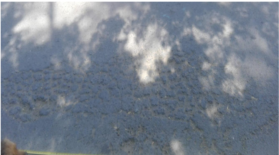
Figura 33. Fisuras de piel de cocodrilo de severidad alta.
