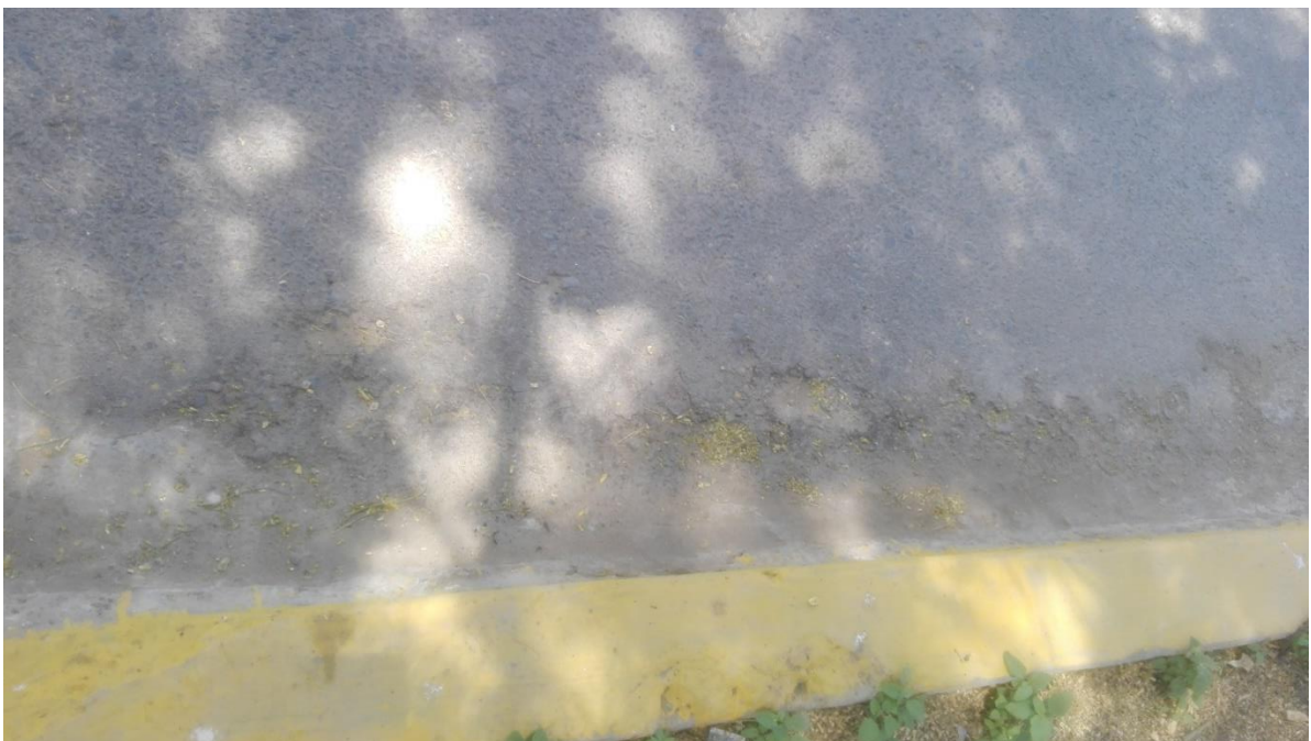
Figura 35. Grietas de borde de alta severidad .
