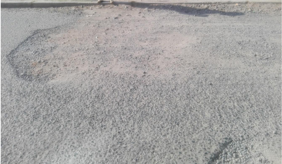
Figura 32. Desprendimiento de agregados de alta severidad
