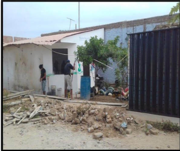
Figure 85. Centro Educativo Juan Ramón, Cerco perimétrico derruido
