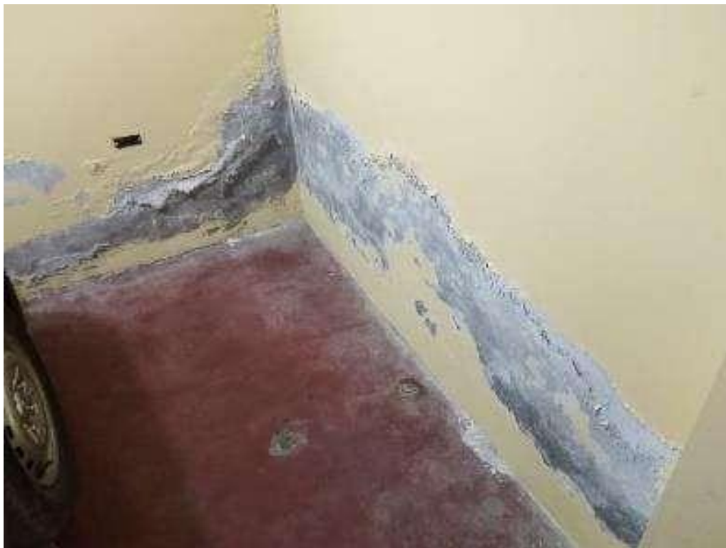
Muros afectados por filtración de agua en el canal
