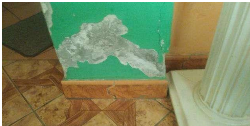
Columnas afectadas por filtración de agua
