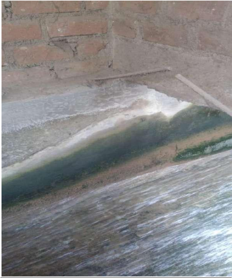
Canal de concreto con deterioro y daños
