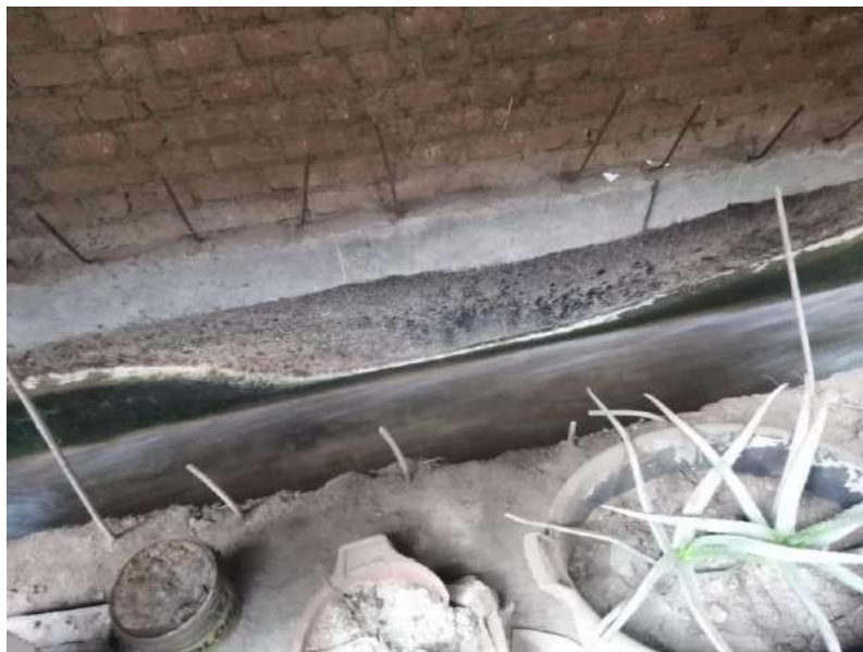
Marcas de fluido en el canal
