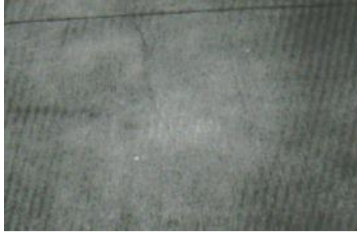
Figura 36. Grieta de Contracción:
