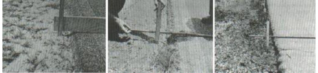
Figura 18. Desnivel Carril / Berma
