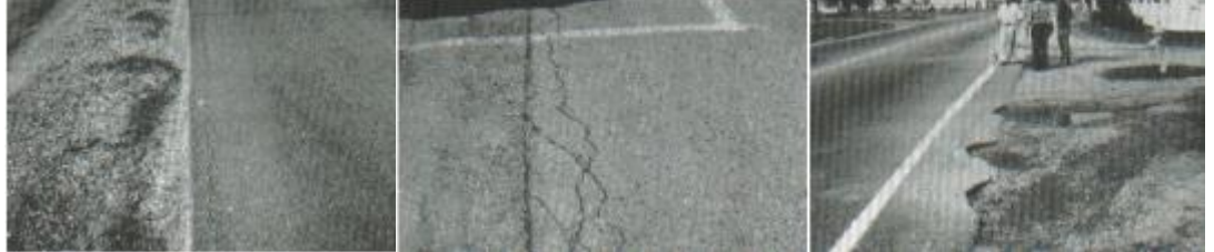
Figura 04. Grieta de Borde
