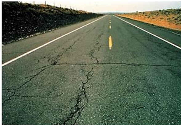
Figura 03. Agrietamiento en Bloque
