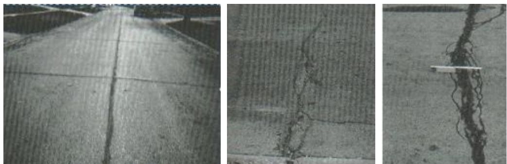
Figura 05. Grieta de Reflexión de Junta
