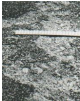
Figura 35. Descascaramiento, Mapa de Fisuras, Craquelado
