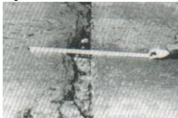
Figura 38. Descascaramiento de Junta:
