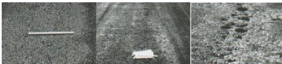
Figura 15. Desprendimiento de Agregados
