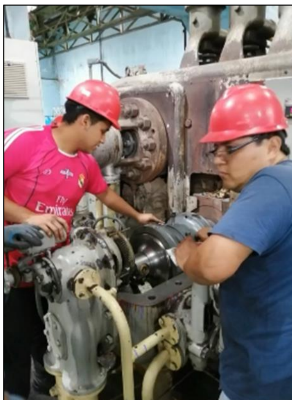
Figura 19. Mantenimiento al gobernador de la turbina.
