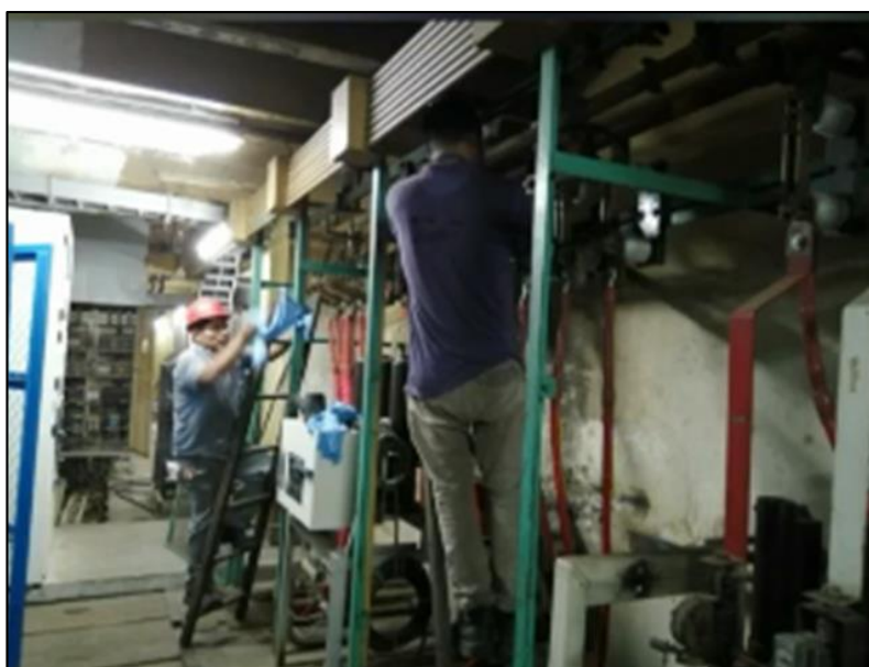
Figura 24. Revisión general de líneas de tensión
