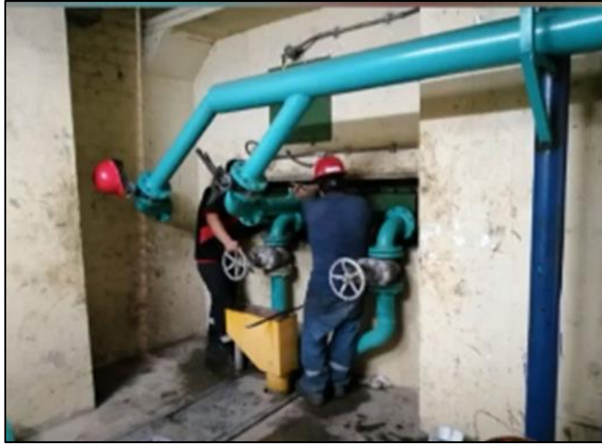
Figura 14. Mantenimiento mensual del sistema de lubricación de la turbina
