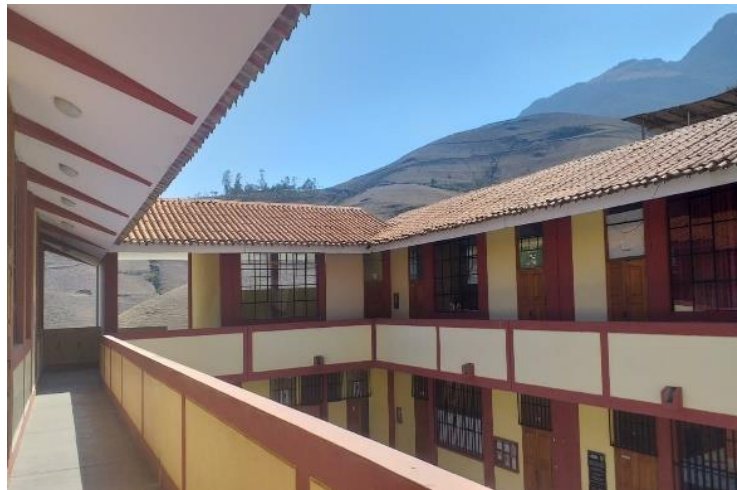
Figura 78. Elementos no estructurales de la I.E. “Santísima Trinidad”
