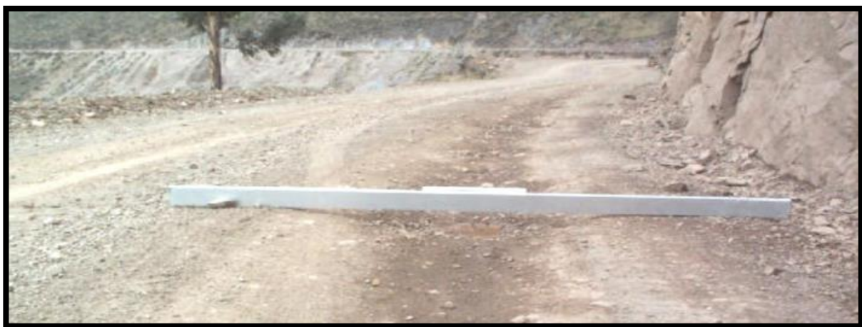
Figura 3. Gravedad 3: Huellas/hundimientos \geq 10 cm.
