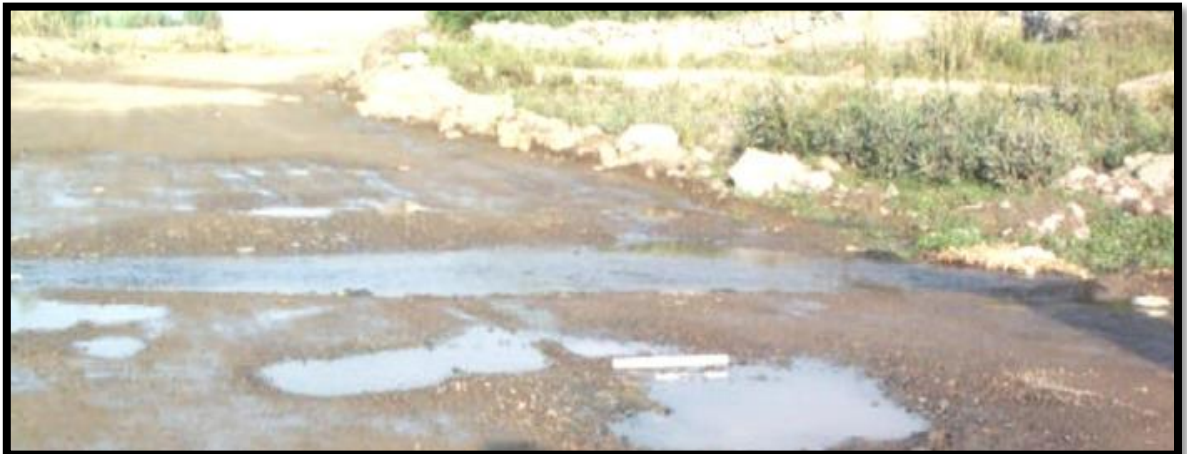
Figura 11. Gravedad 3: necesita una reconstrucción.
