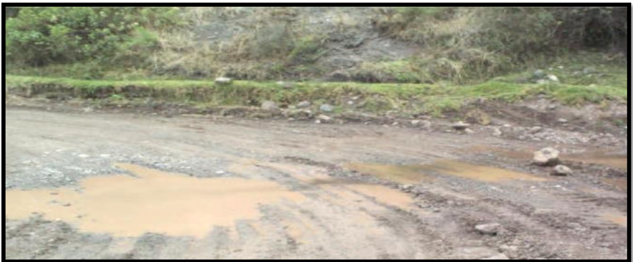
Figura 13. Foto de lodazal en la vía en estudio.
