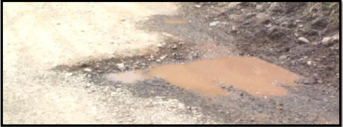
Figura 9: Gravedad 1: Pueden repararse por mantenimiento rutinario.
