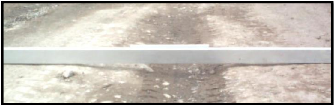
Figura 7: Gravedad 2: Profundidad entre 5 cm y 10 cm.
