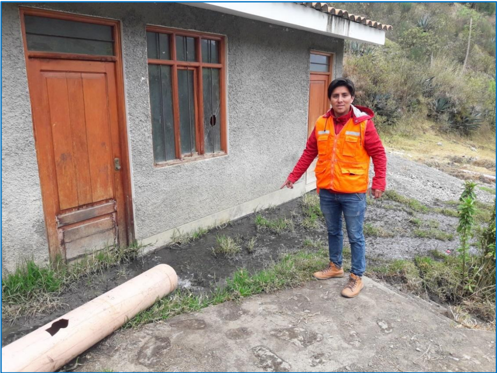
Figura N° 11 - Caseta de seguridad con estructuras debilitadas
