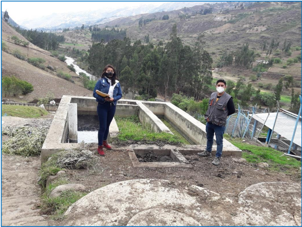
Figura N° 10 - Tanque Imhoff colapsado
