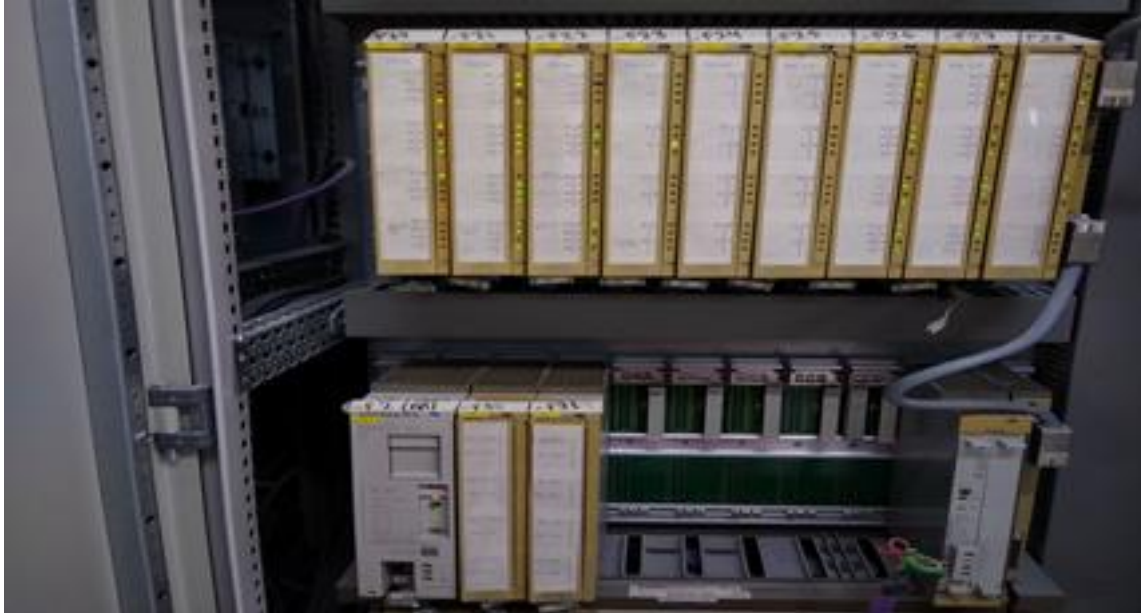
figura 15: Equipos antiguos y obsoletos
