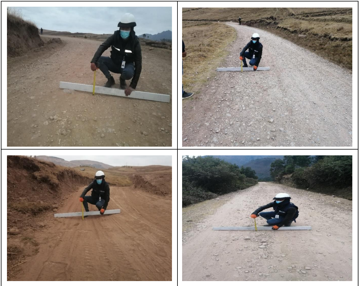
Figura 7. Estado de la plataforma km 70+000 – km 75+000
