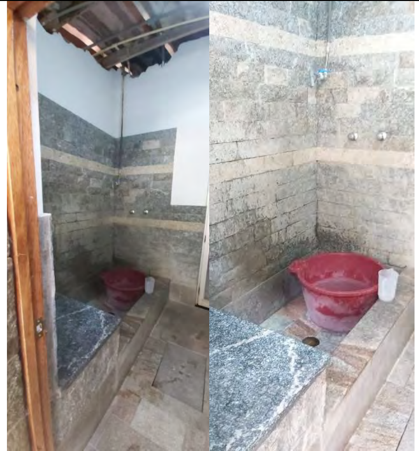
Imagen 20: Interior de las cuevas, tina de agua con recipientes para un la ducha respectiva, el techo se ve precario, presencia de suciedad en las partes bajas de las paredes
