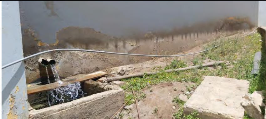
Imagen 08: Se observa las instalaciones electricas y sanitarias ubicadas precariamente en la fachada lateral principal de los Baños termales.
