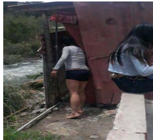
Imagen 8: Vestidores en estado precario y con peligro de desplomarse.
