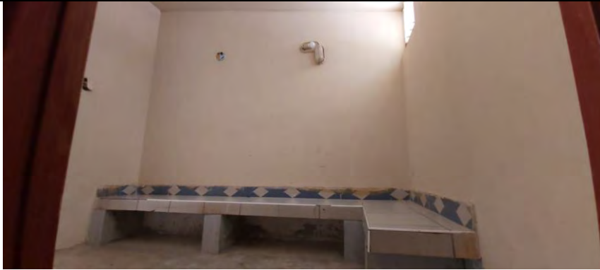
Imagen 12: Interior de los vestuarios de las damas en la zona de la piscina de niños, presencia de hongos en las bancas, paredes manchadas de un color amarillento.
