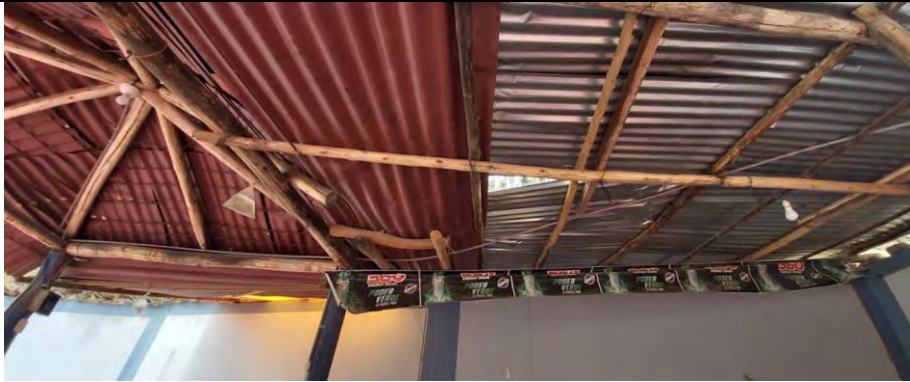
Imagen 06: Se observa las instalaciones electricas ubicadas precariamente, los cables se perciben en la estructura de madera.
