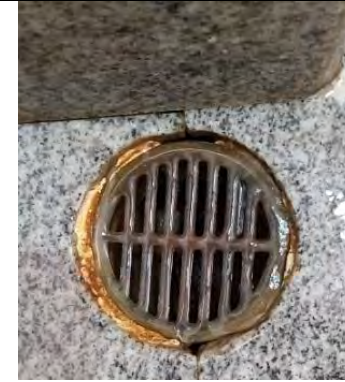
Imagen 15: Interior de las pozas, presencia de hongos en el sumidero.
