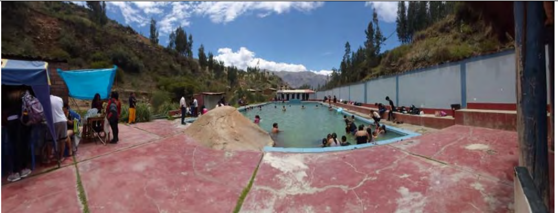
Imagen 30: Área de la piscina para adultos, se presencia las rajaduras del piso por el pasar del tiempo en cemento pulido de color guinda, crecimiento de de hierbas en las juntas; empozamiento de agua en las partes laterales de la piscina, los vestuarios y duchas al costado y al fondo.Vista del entorno natural.
