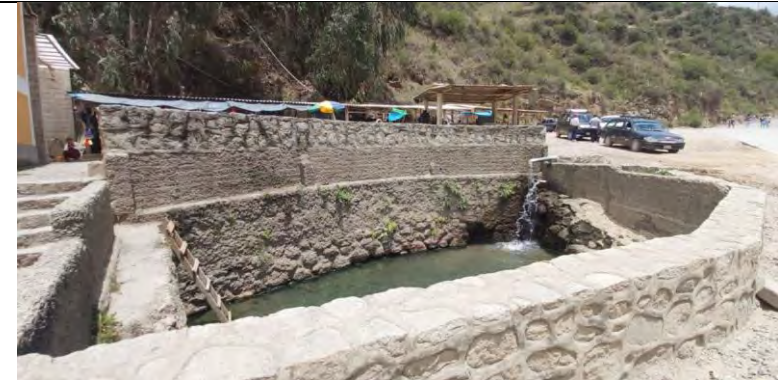
Imagen 09: Se observa las instalaciones sanitarias ubicadas sin mantenimiento en la fachada principal de los Baños termales.
