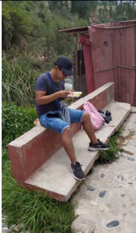
Imagen 25: Las bancas de concreto, zona de piscina adultos, están rotas. Los vestuarios instalados de forma precaria con calamina polipropileno.
