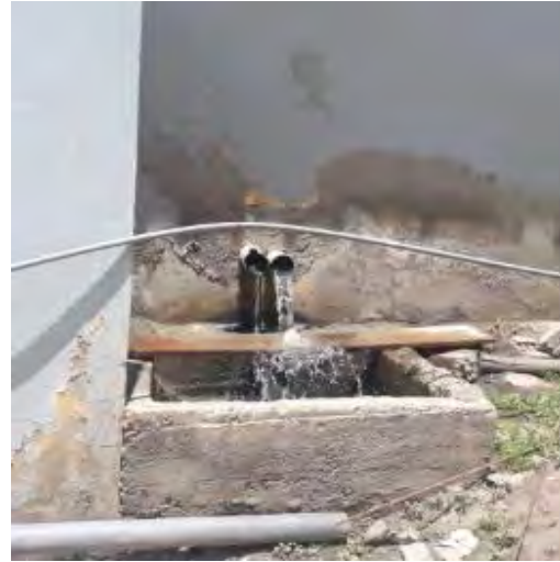
Imagen 24: Tuberías a la vista libre de cualquiera que pase por la carretera.
