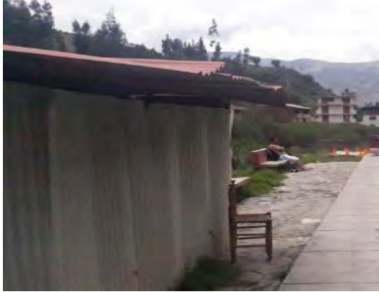
Imagen 9: Cobertura de techo a base de polipropileno simple presenta peligro.
