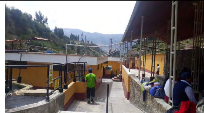
Imagen 07: Se observa las instalaciones electricas ubicadas precariamente, los cables se perciben debajo de la cobertura del techo
