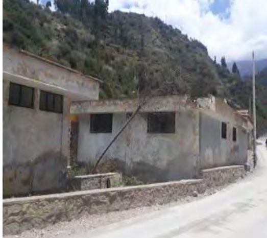
Imagen 12: Muros con presencia de moho y descascara miento del tarrajeo.
