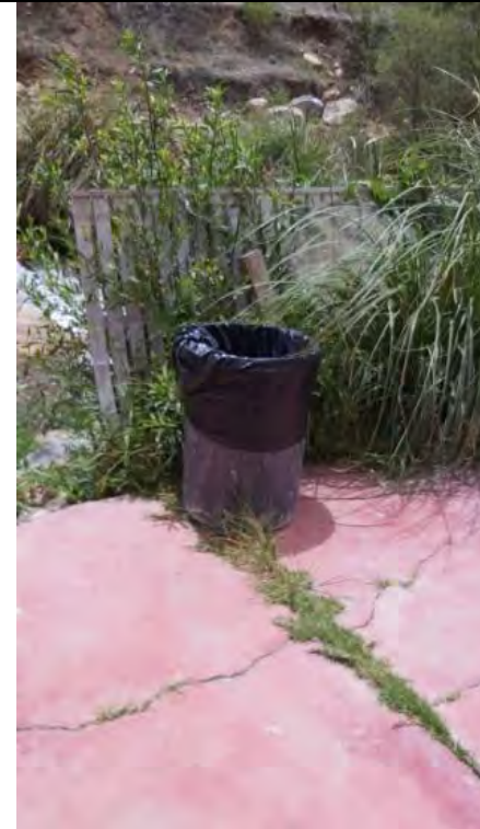
Imagen 27: Se observa los tachos de basura sin ninguna indicación, el piso con rajaduras por el pasar del tiempo, en las juntas se presencia hierbas.
