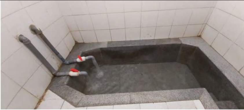
Imagen 14: Interior de las pozas, presencia de hongos en las juntas de las mayólicas.
