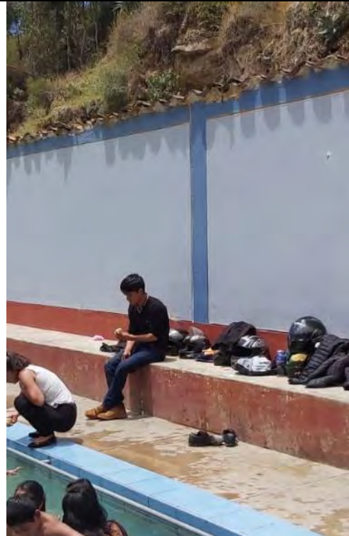
Imagen 26: Las bancas de concreto, zona de piscina adultos, se encuentran con presencia de hongos y sucias, se observa las pertenencias de los turistas en las bancas.
